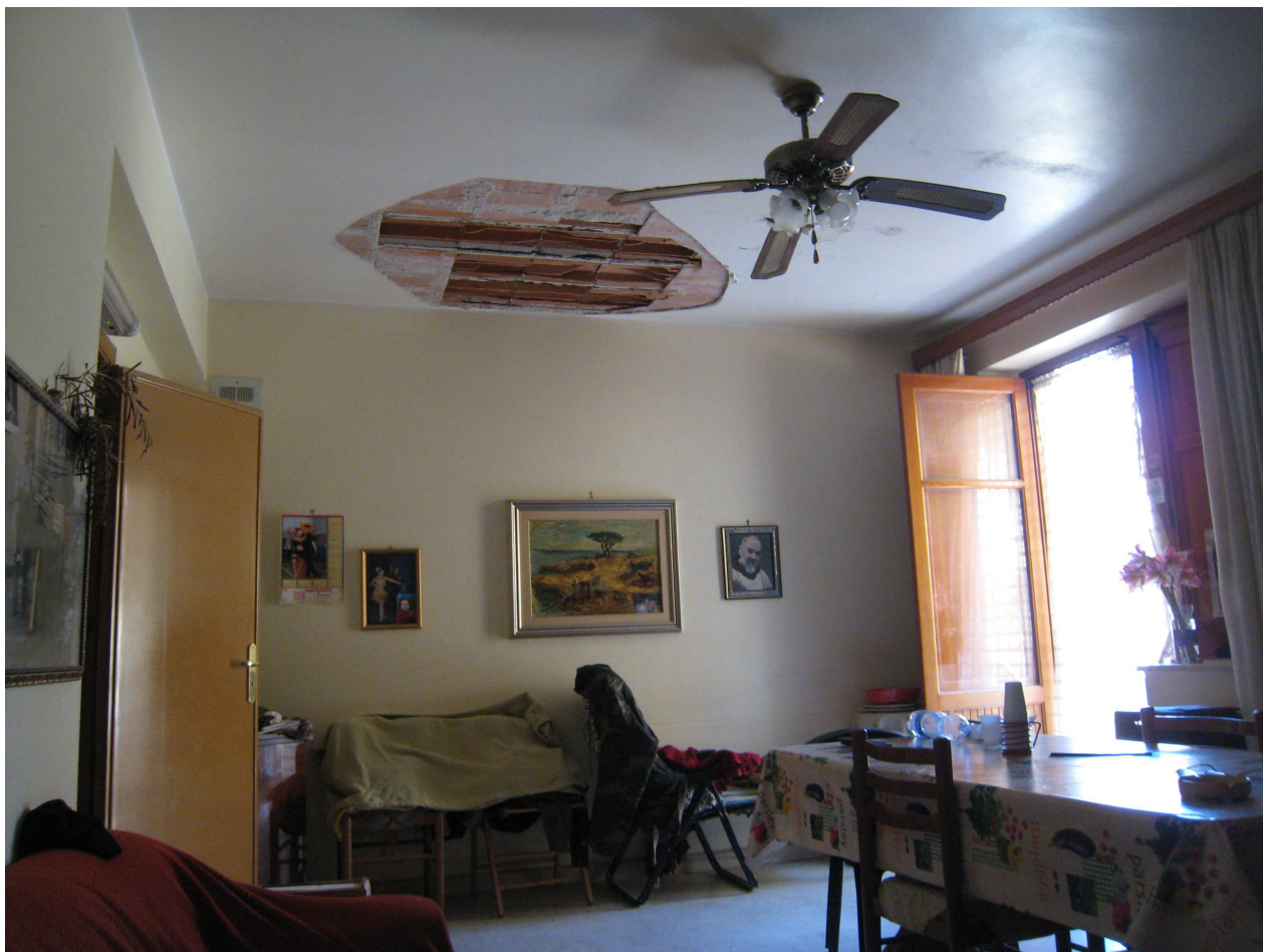
Foto n. 16. Il soggiorno-pranzo. Dal tetto sono caduti pezzi di intonaco e di laterizi a causa della vetustà del fabbricato.
