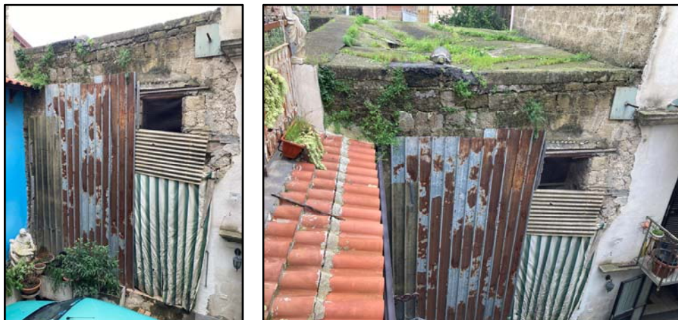
Proprietà aliena presente nel cortile comune in stato fatiscente
