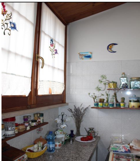
CUCINA AL PIANO SECONDO – NON REGOLARE E NON SANABILE CON TALE DESTINAZIONE, IN QUANTO SAREBBE LA SECONDA CUCINA IN UNA UNICA UNITA' ABITATIVA
