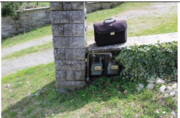
CONTATORE GAS DELL'ABITAZIONE ESECUTATA E DI QUELLA ADIACENTE
