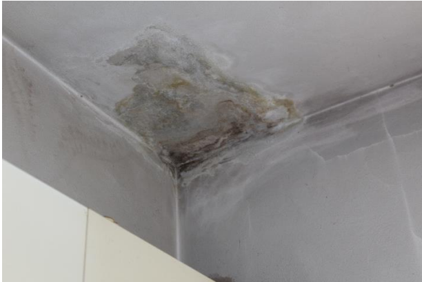
INFILTRAZIONE D'ACQUA ALLA CUCINA PIANO PRIMO
