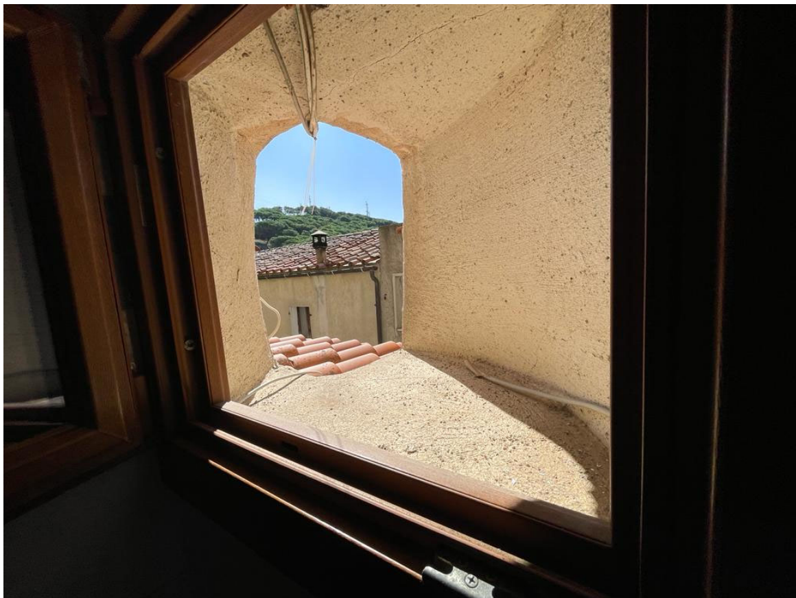
Foto 10: Finestra aperta in assenza di autorizzazione
