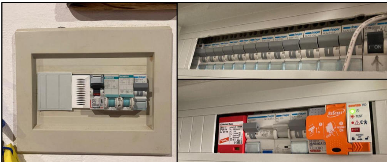
Impianto elettrico: i quadri presenti internamente ed esternamente all'unità
