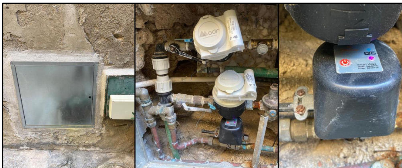
Impianto idrico: contatore in vano esterno
