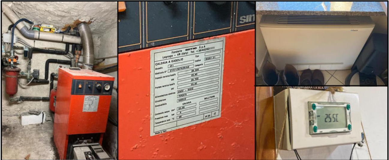
Impianto riscaldamento: caldaia, ventilconvettori, termostato.
