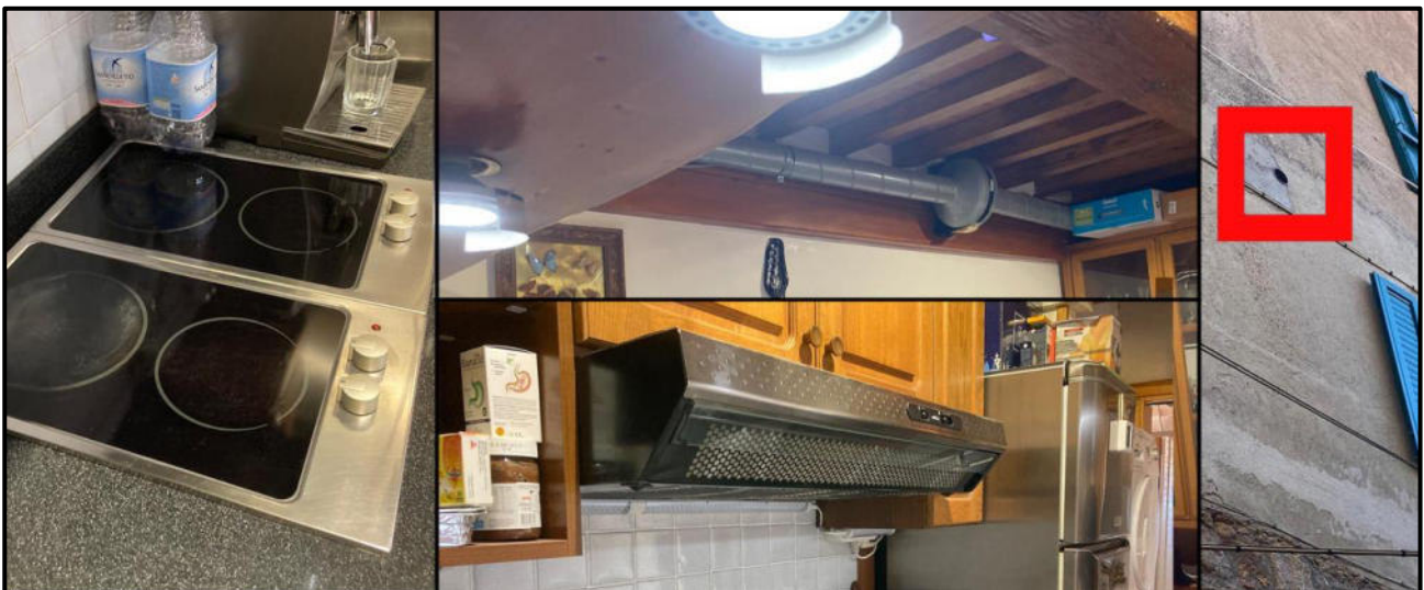
Impianto gas: piano cottura con cappa areante
