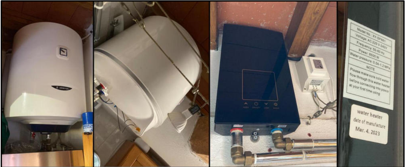
Impianto idrico: produzione ACS
