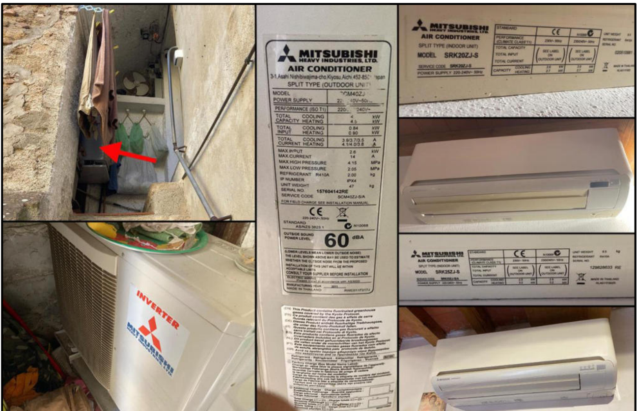
Impianto raffrescamento: pompa di calore esterna e split interni
