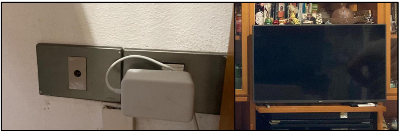
Impianto radio-televisivo: apparecchio tv e presa antenna
