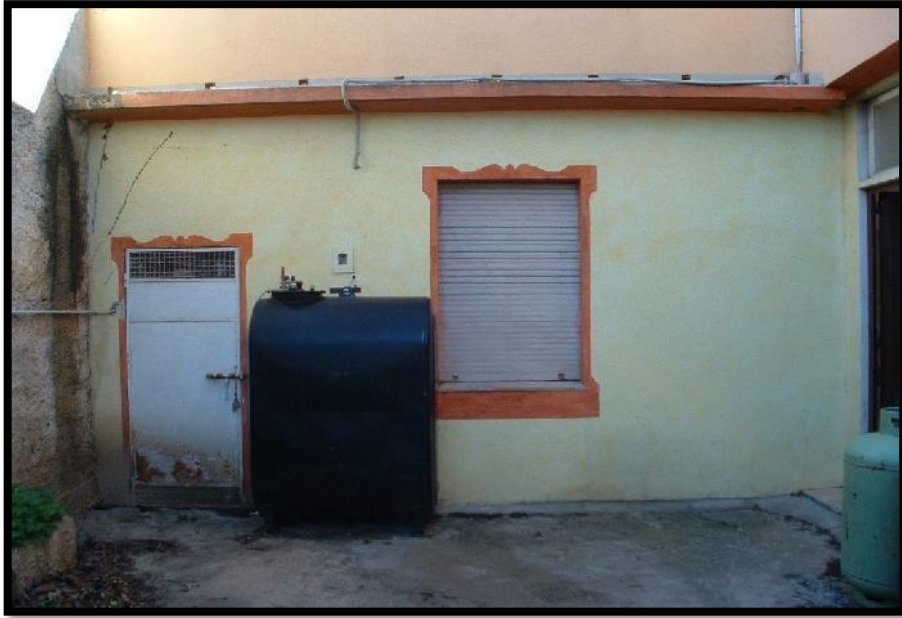
FOTO 6_ Locale caldaia con deposito esterno a servizio dell'impianto del sub5
