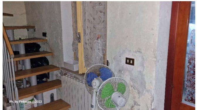
20. P. terra: corpo scala in difformità
