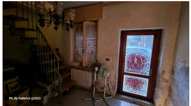
22. P. terra: camera con scala in difformità
