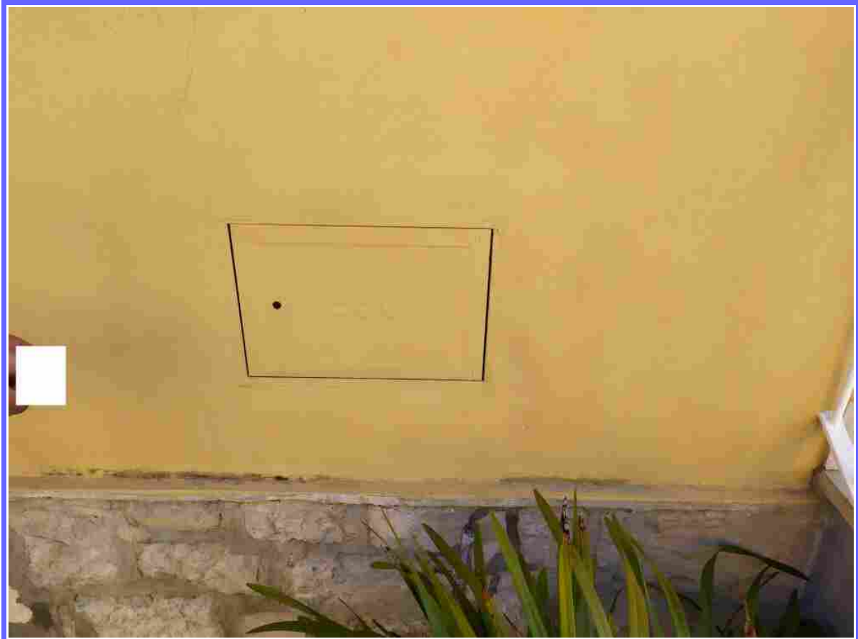
FOTO 47 - CONTATORE ACQUA - FRONTE FABBRICATO
