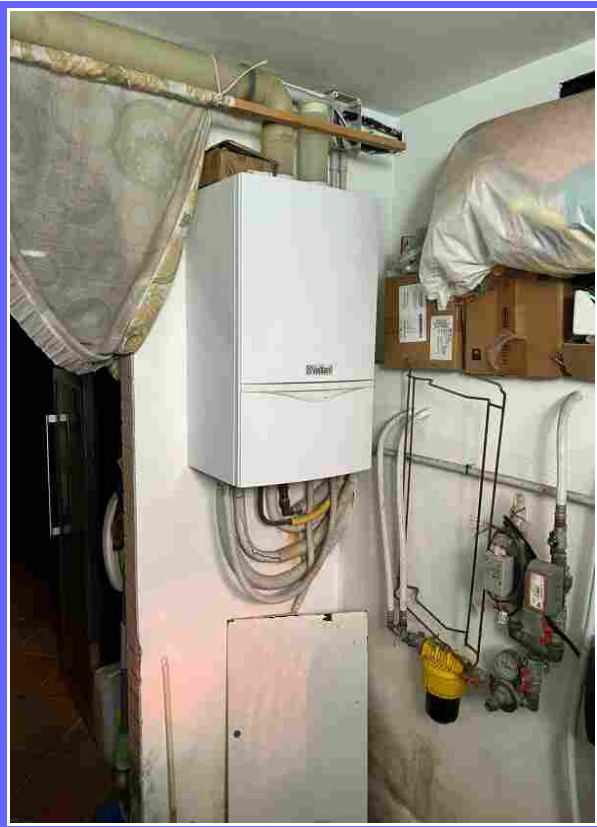
FOTO 45 - CALDAIA IN CANTINA - DEPOSITO
