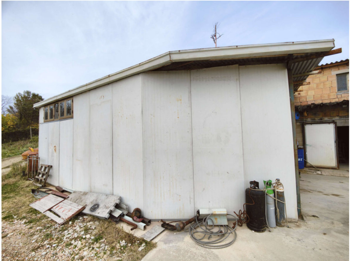
11) Struttura precaria (3) da rimuovere
