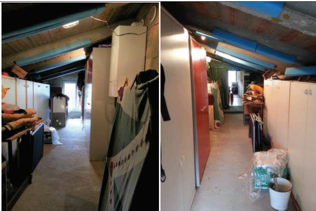
Foto 62-63 – Soffitta 2. Si osserva la caldaia dell'impianto termosanitario dell'appartamento.
