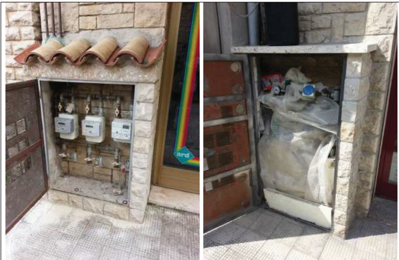
Foto 76-77 – Contatori del gas metano e dell'acqua in armadietti posti perimetralmente all'edificio.
