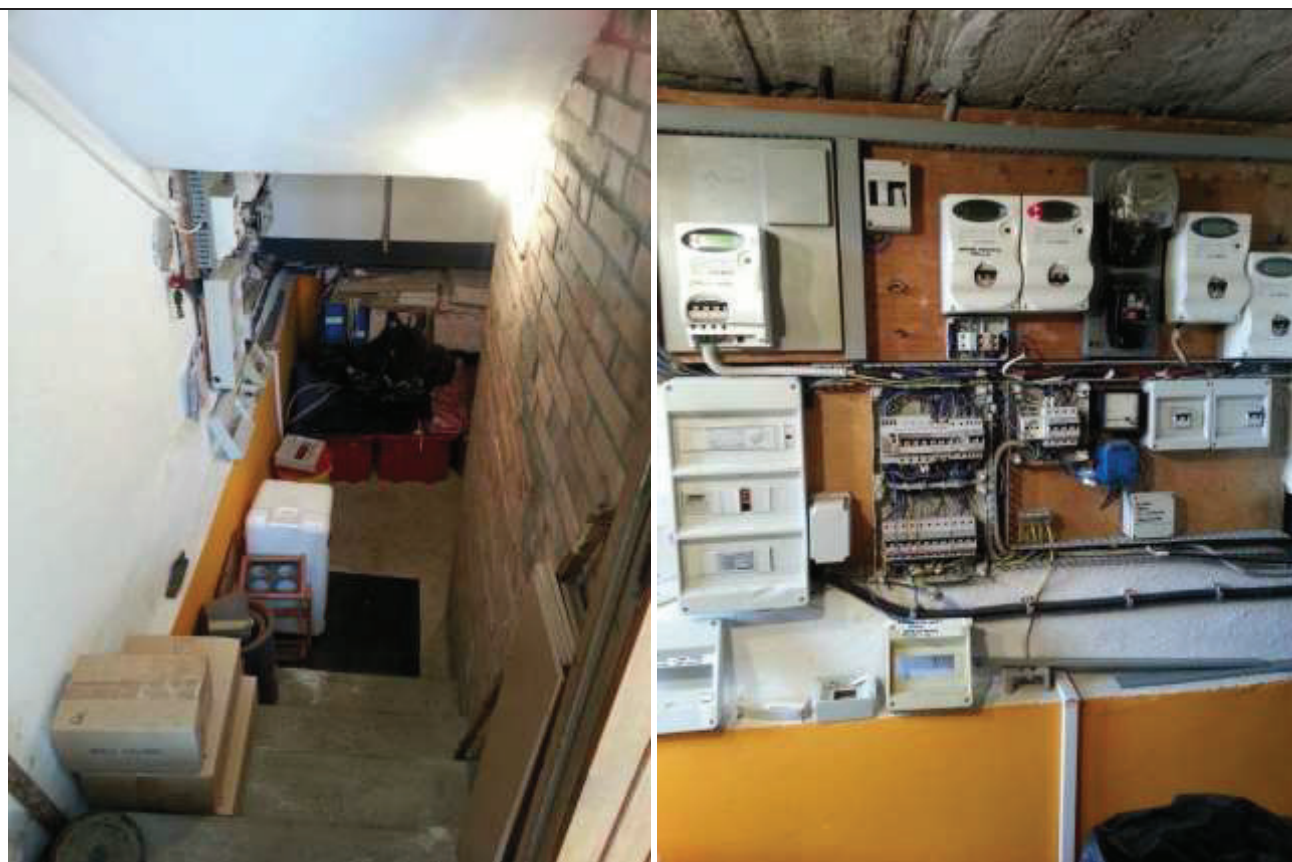
Foto 74-75 – Contatori elettrici nel vano sottoscala comune.
