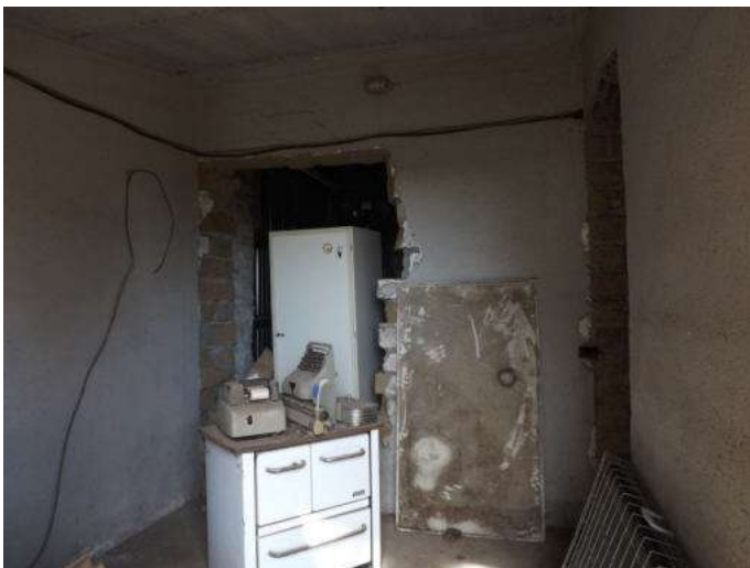
46 - Apertura verso il locale retrostante non pignorato
