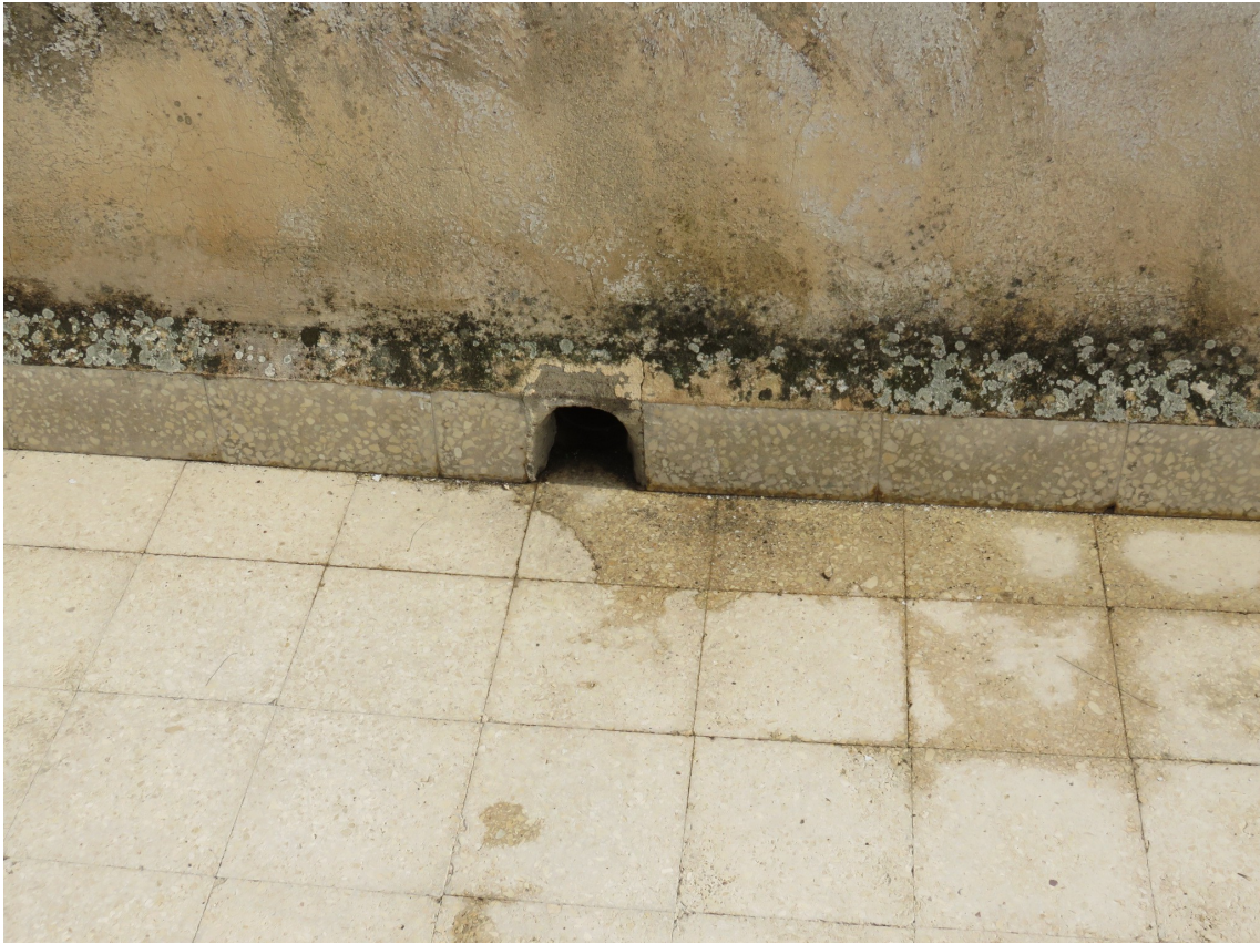
Foto 45 - Terrazzo 2° piano, Particolare scarico causa umidità a letto 2 al 1° p.
