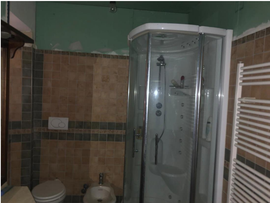
Foto 12: Locale bagno piano primo
