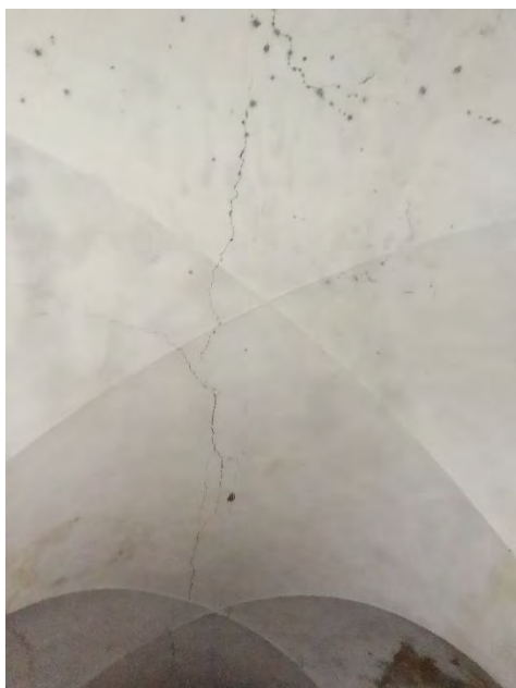
interno e lesioni del fabbricato p.lla 10
