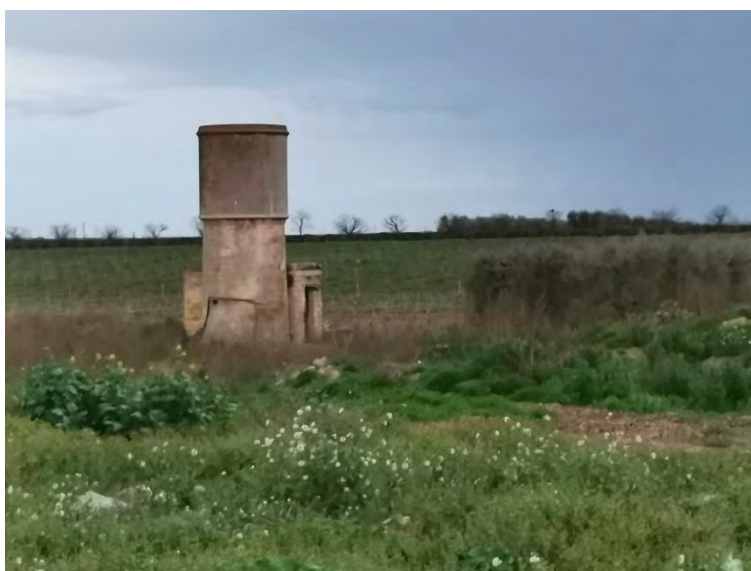
Rudere del fabbricato in p.lla 6
