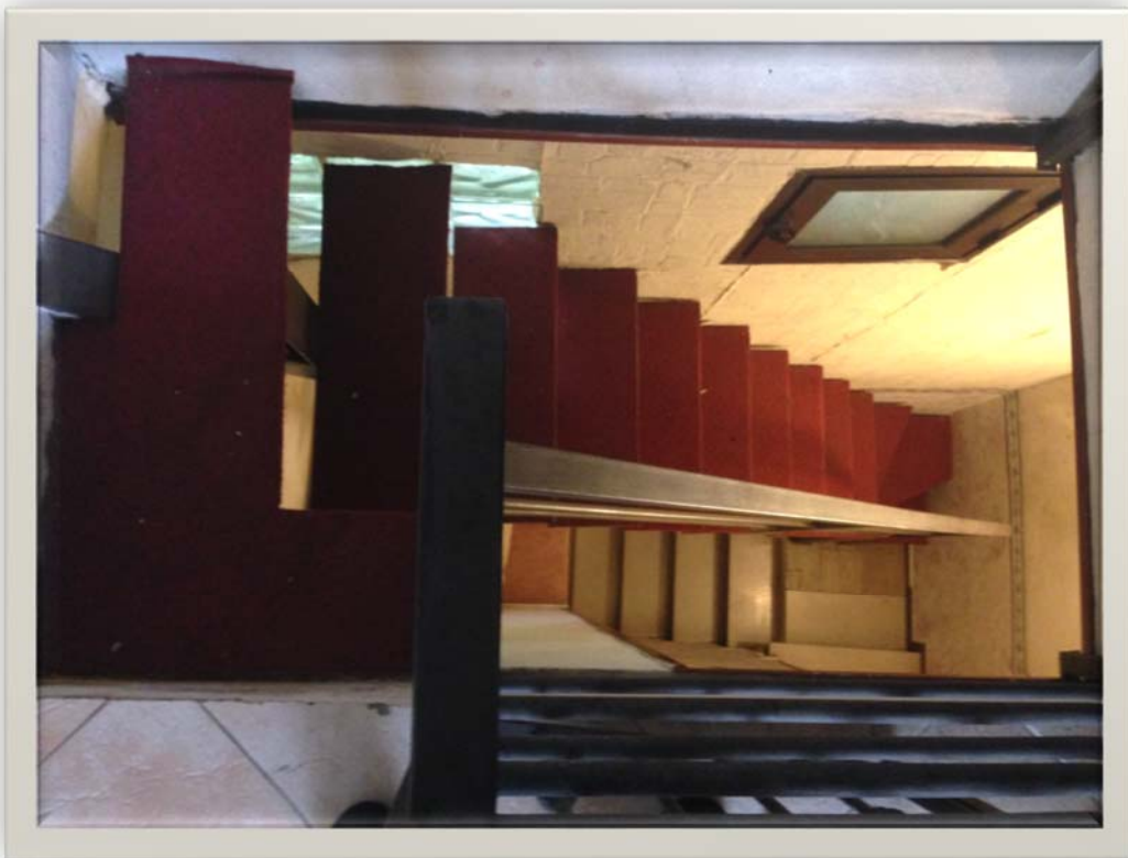
Particolare della scala in ferro di accesso al terzo piano abusivo
