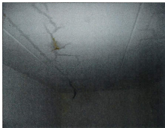
Particolare infiltrazione Lotto 2
