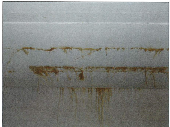
Particolare infiltrazione box Lotto 3
