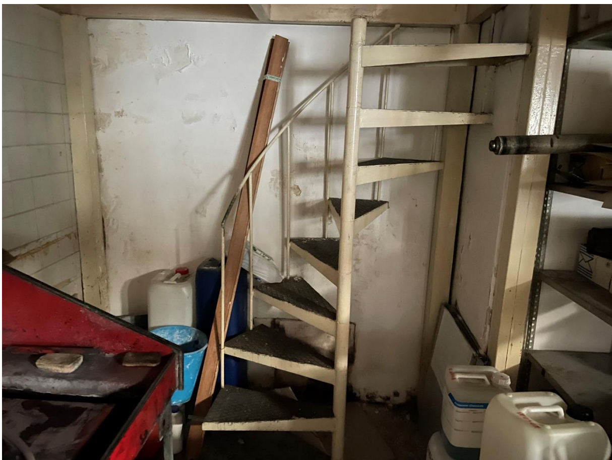
Foto n. 8: Vista della scala a chiocciola metallica che consente di raggiungere il soppalco.
