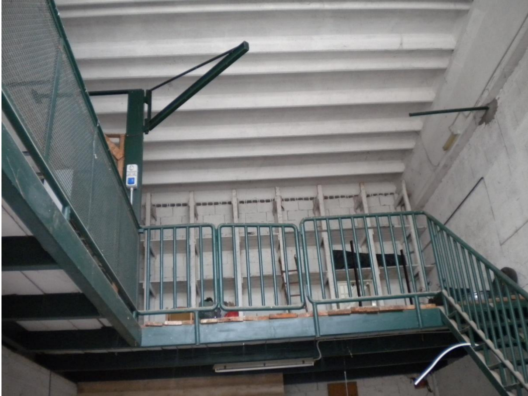
Soppalco nel deposito
