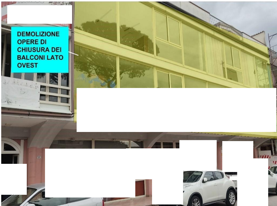
Evidenza delle opere di chiusura non autorizzate dei balconi al 1° e 2° piano, posti sul lato Ovest del fabbricato di cui fanno parte gli immobili espropriati
