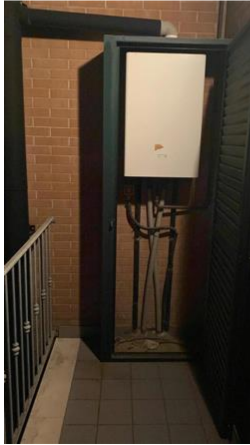
Balcone con caldaia P1
