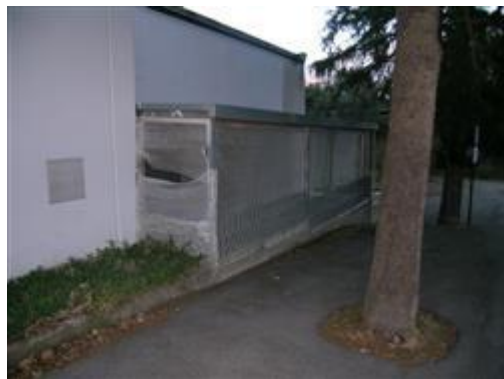
Tettoia non autorizzata da rimuovere
