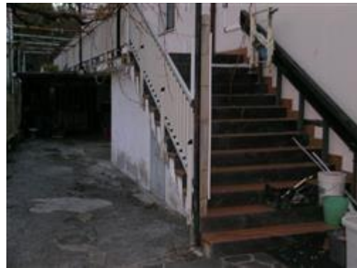
Servoscala (non funzionante) per barriere architettoniche
