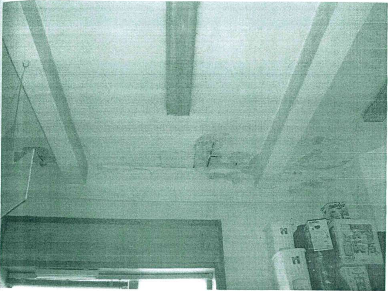
PARTICOLARE DELL'UMIDITA' CHE SI RISCONTRA NEL SOFFITTO DEL NEGOZIO
