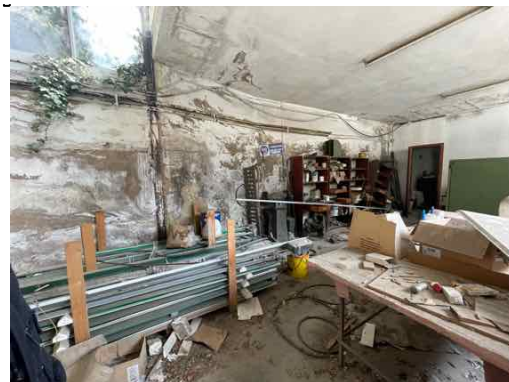
zona uffici fatiscente
