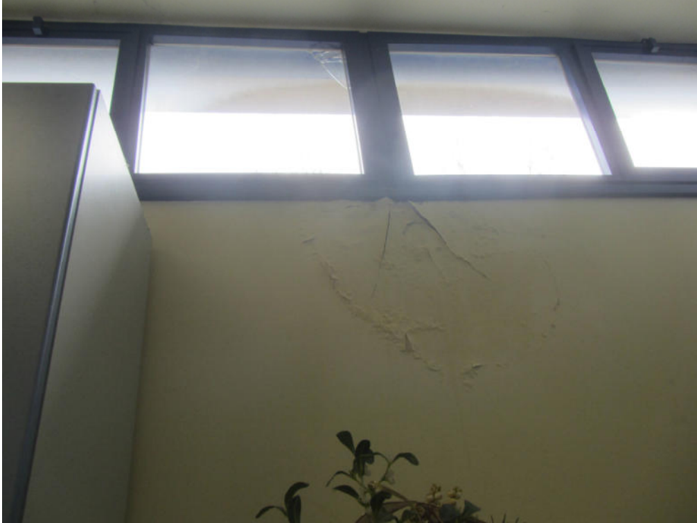
Foto n. 05 – vista dell'infiltrazione d'acqua all'interno del negozio
