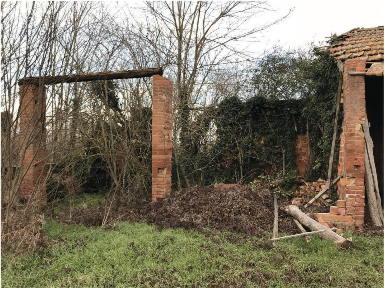
FOTO 31 - SCORCIO DELLA PARTE CROLLATA DELL'ANNESSO 3
