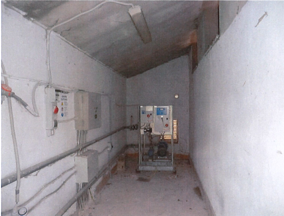
interno locale pompe antincendio
