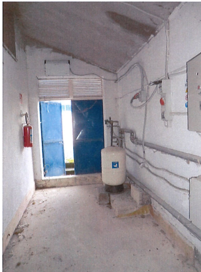
interno locale pompe antincendio
