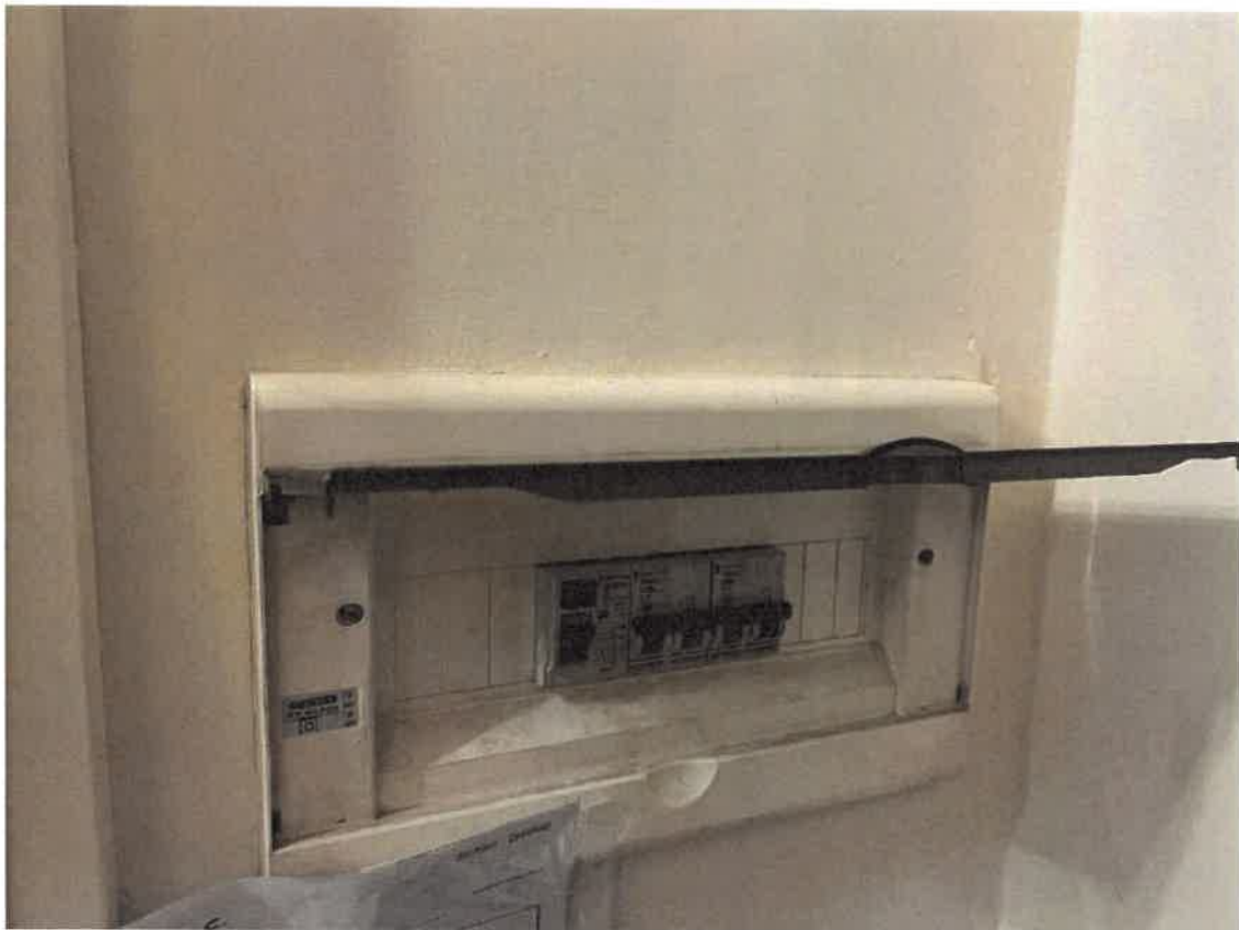
Figura 18 particolare impianto elettrico
