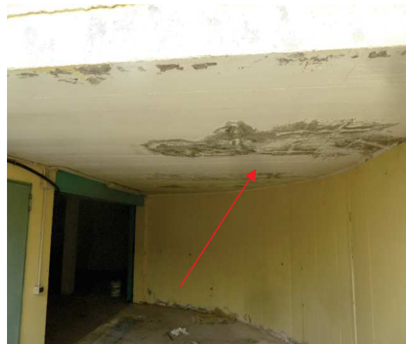
Foto n. 42 infiltrazioni lato garage
