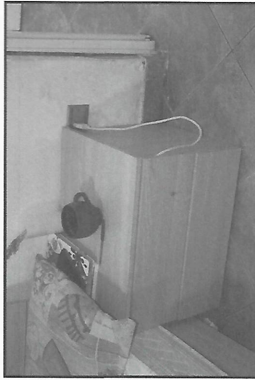
15 Umidità di risalita
