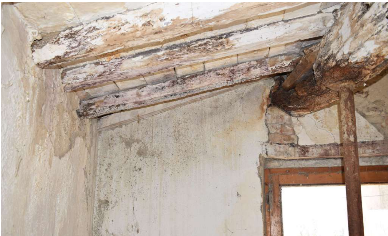
Foto n. 34_ Sopralluogo del 19/04/2019 Podere Capaccia, casa colonica, appartamento sub 5: particolare delle condizioni di degrado
