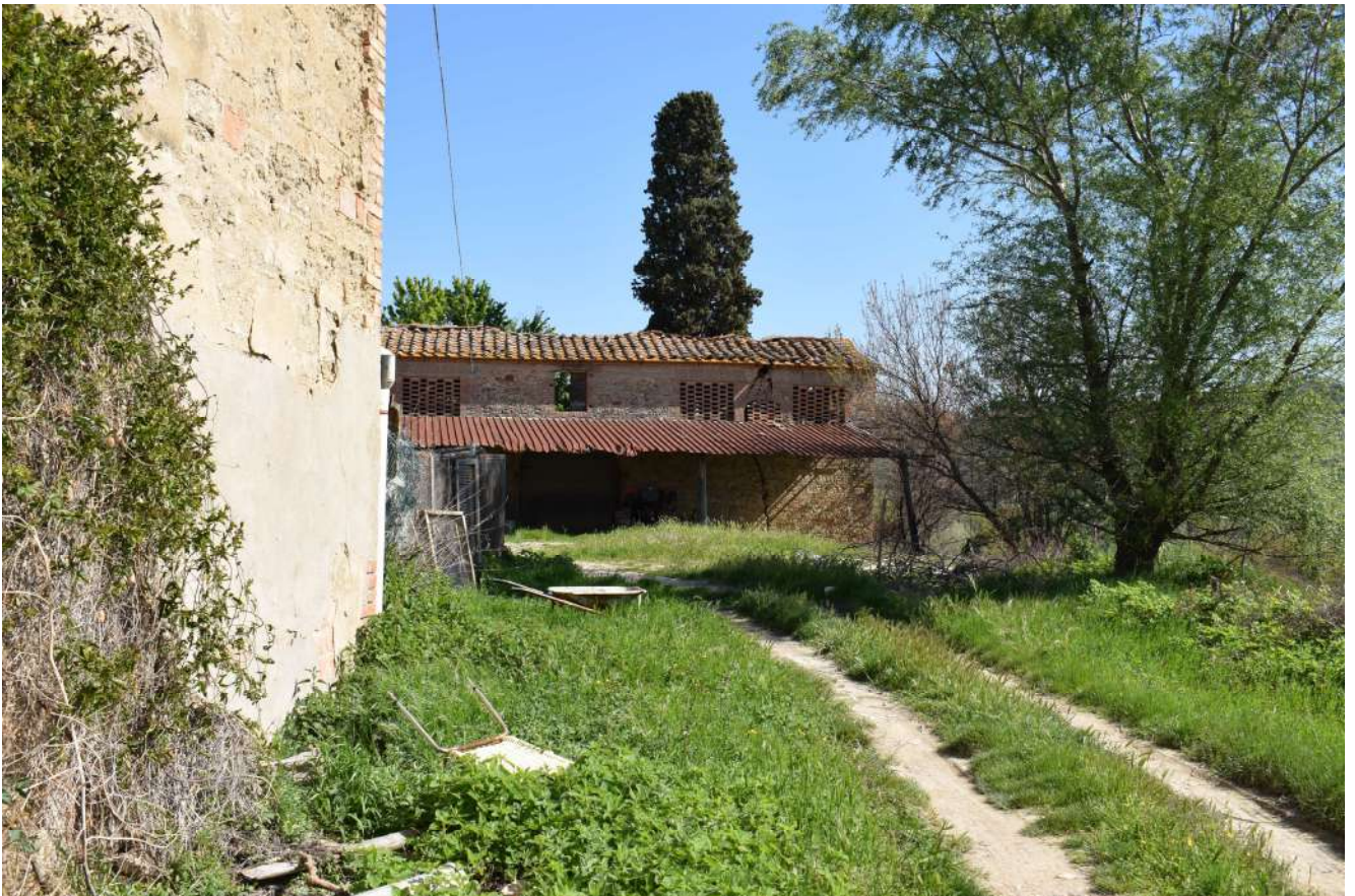
Foto n. 6_ Sopralluogo del 19/04/2019 Podere Capaccia: dalla stradella che gira intorno alla casa, vista sul fienile abbandonato e pericolante (sub 7)
