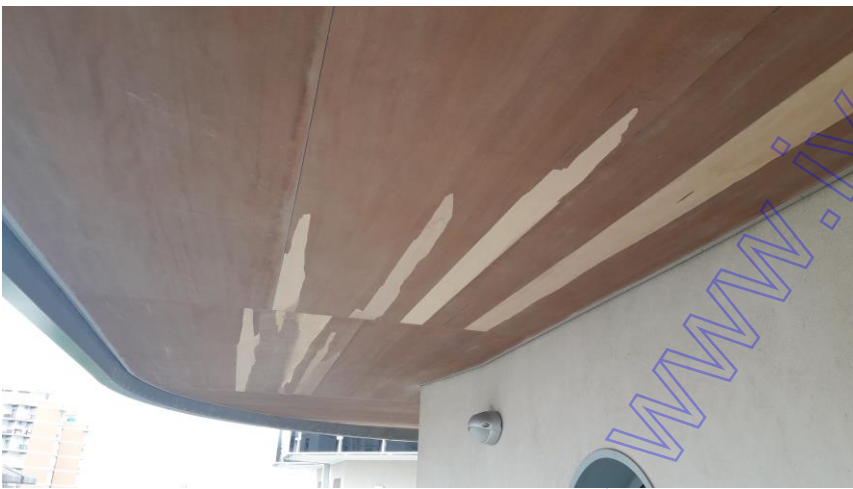
Soffitto terrazza deteriorato
