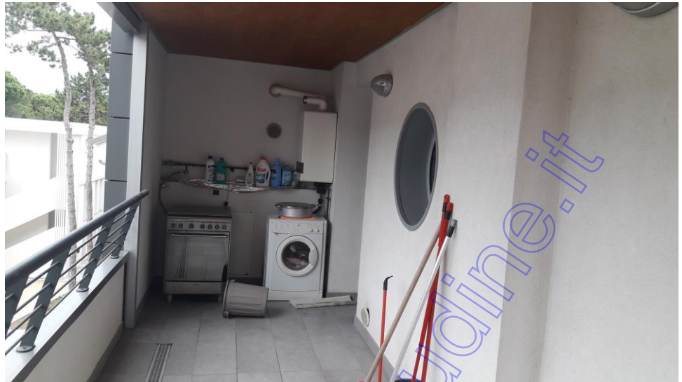
(Caldaia ed altre attrezzature in terrazza)
