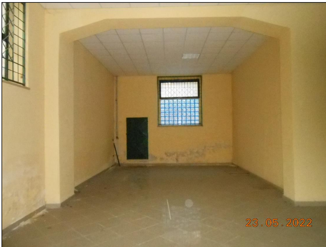
FOTO N. 15 Vista interna a P.T. dell'immobile. Si notano macchie d'umidità di risalita sulle pareti.
