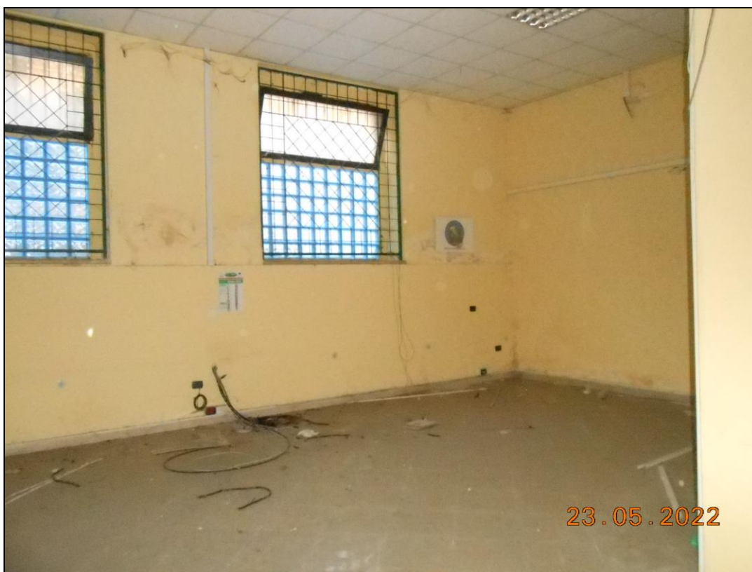
FOTO N. 20 Vista interna dei locali dell'immobile. Si notano i cavi elettrici sfilati dalle tubazioni.
