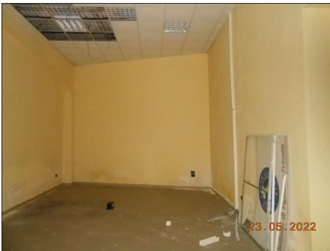
FOTO N. 40 Vista interna dell'immobile. Si notano macchie d'umidità ed efflorescenza sulle pareti.
