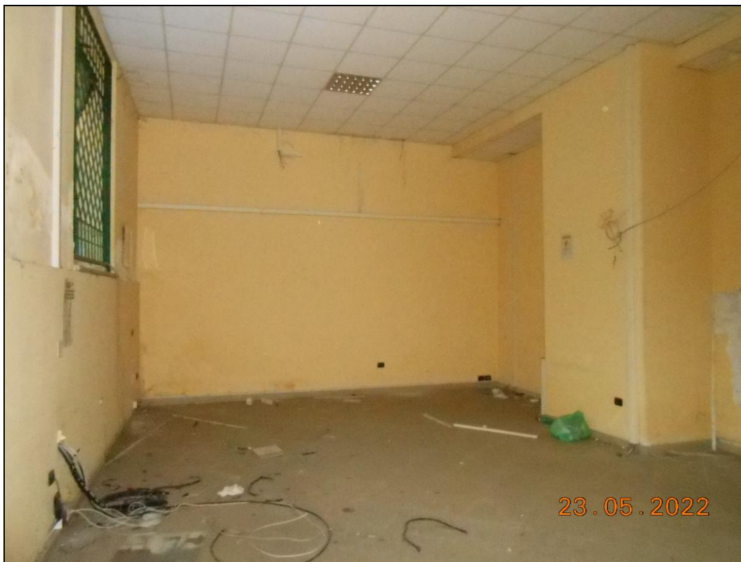
FOTO N. 21 Vista interna dei locali dell'immobile. Si notano i cavi elettrici sfilati dalle tubazioni.
