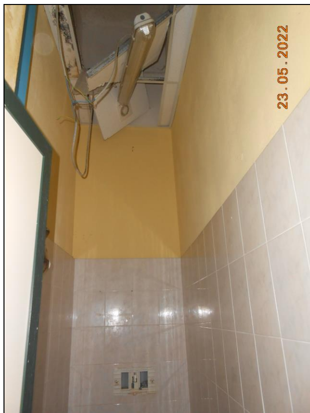
FOTO N. 37 Vista interna dell'immobile. Si nota la controsoffittatura sfondata.
