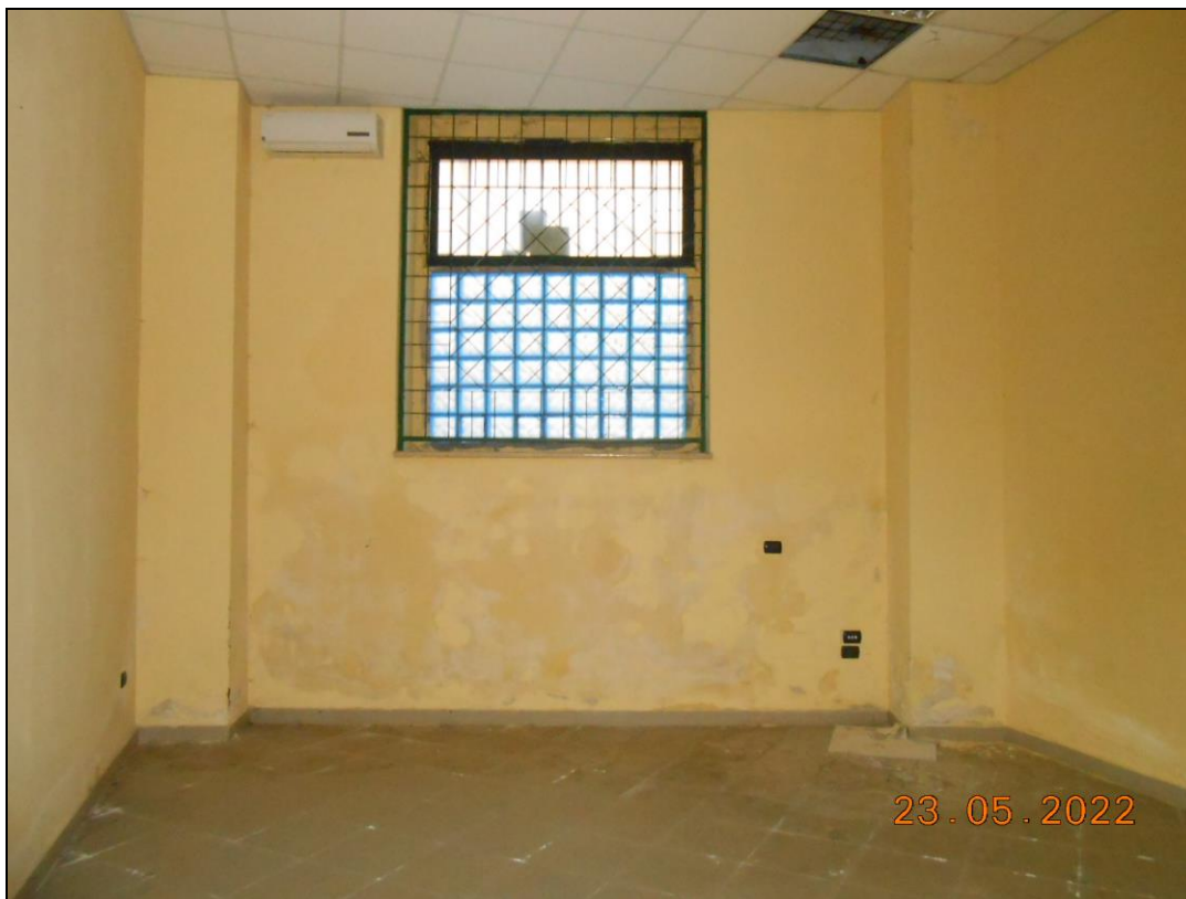
FOTO N. 27 Vista interna dei locali dell'immobile. Si nota l'umidità sulle pareti.
