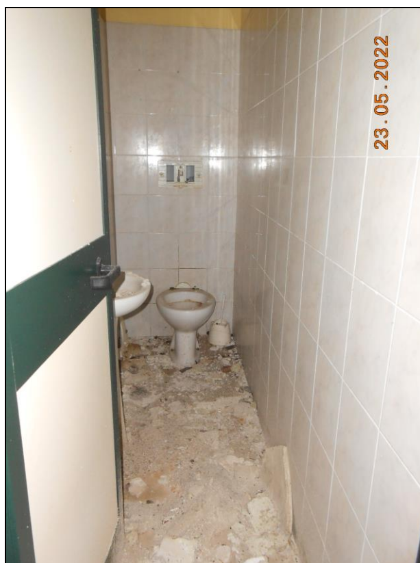
FOTO N. 36 Vista dei w.c.. Si nota lo stato di degrado.
