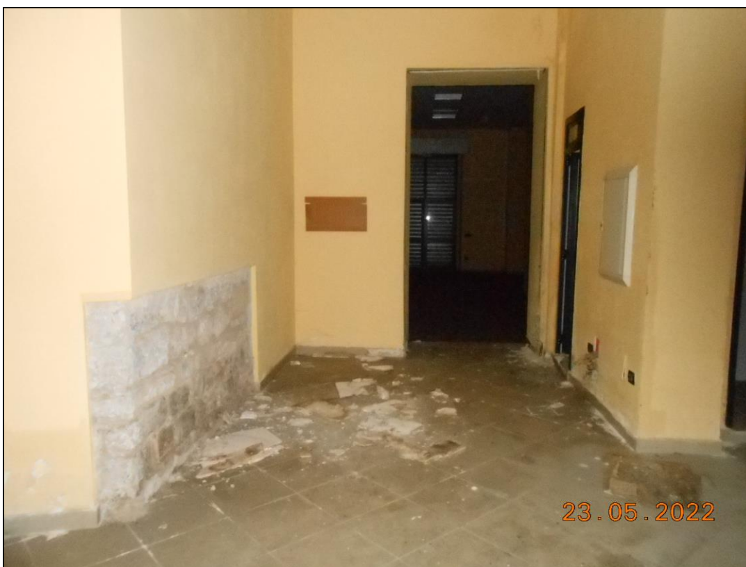
FOTO N. 44 Vista interna dell'immobile. Si notano materiali sul pavimento.
