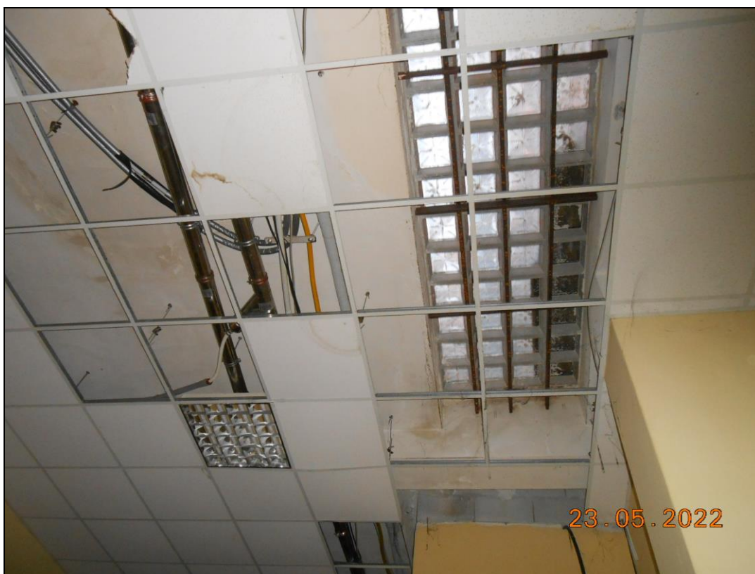
FOTO N. 30 Vista interna dei locali dell'immobile. Si nota gli impianti asportati.
