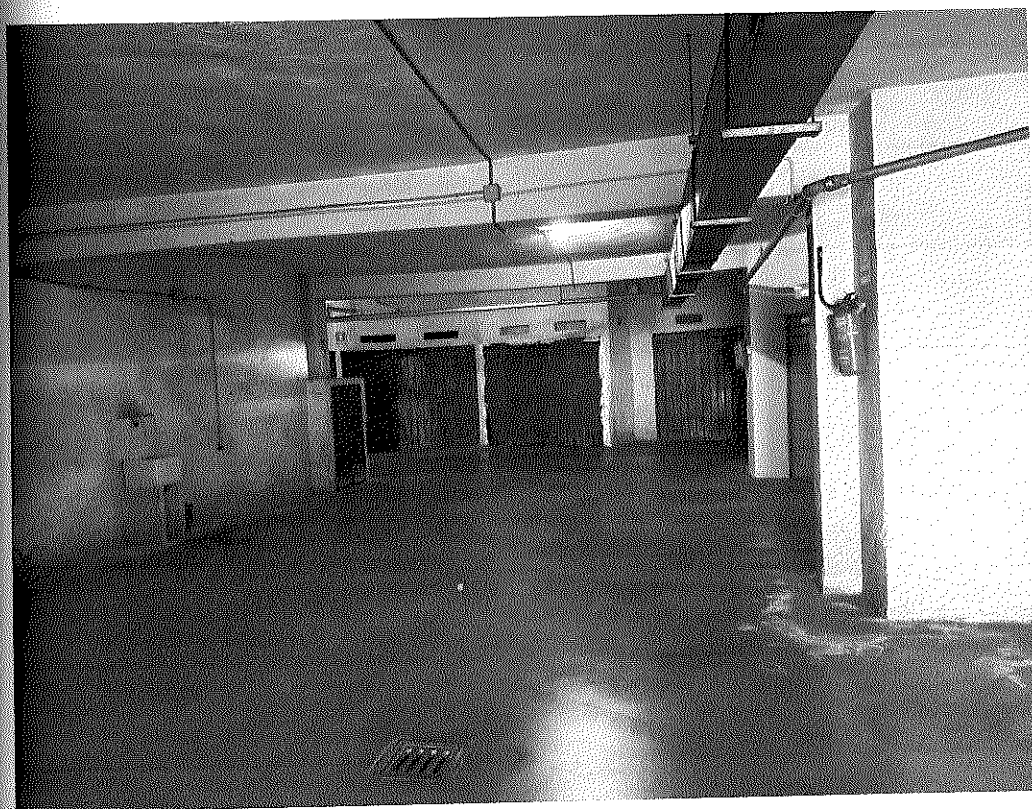
FOTO N. 14 – Vista dell'area di manovra che da accesso ai box dove si evidenzia in fondo il box oggetto di stima con porta a sinistra.
