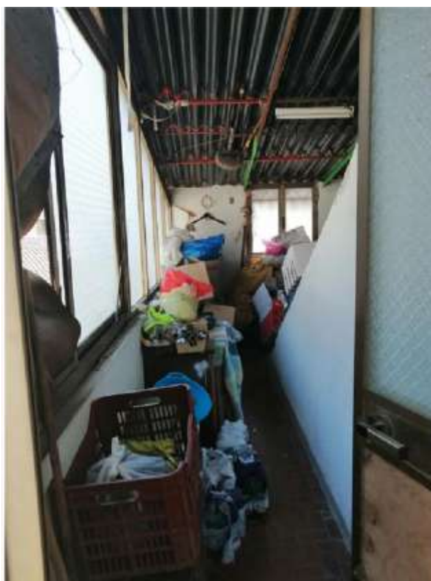
Foto n. 6 – Ballatoio chiuso abusivamente (vista interna)
