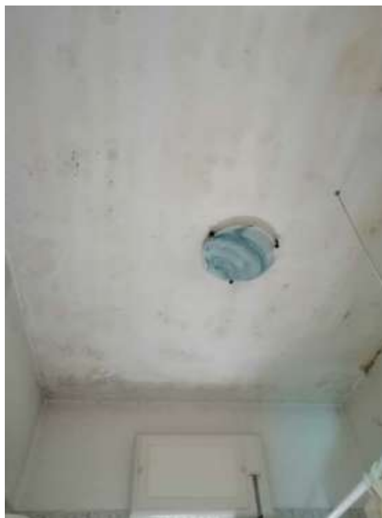
Foto n. 19 - tracce del fenomeno infiltrativo
