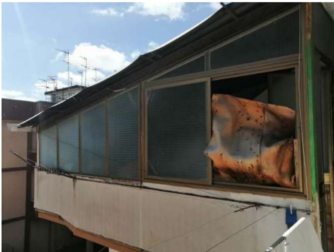
Foto n. 5 – Ballatoio del vano scala posto al secondo piano, prospiciente l’ingresso dell’appartamento, chiuso abusivamente (vista dal ballatoio)
