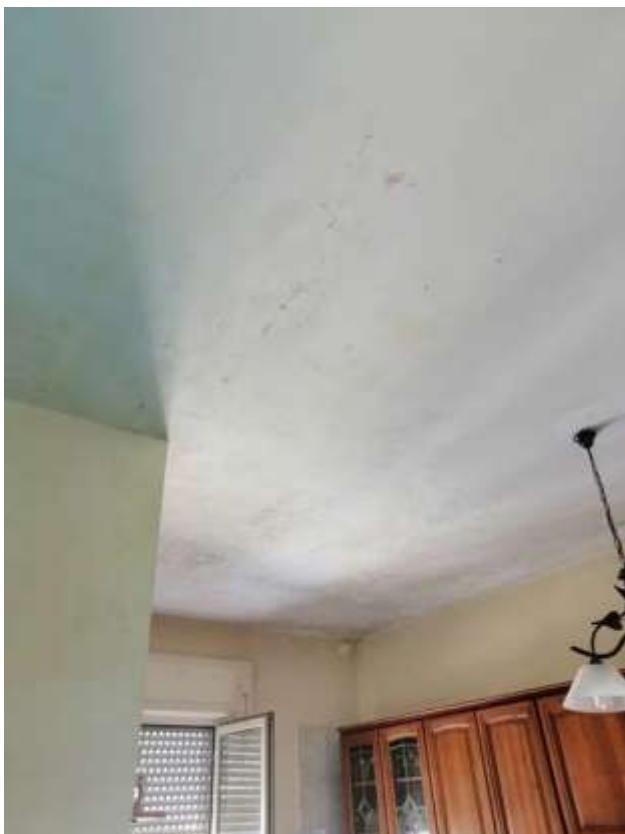
Foto n. 16 – tracce del fenomeno infiltrativo
