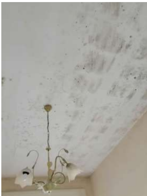
Foto n. 18 - tracce del fenomeno infiltrativo
