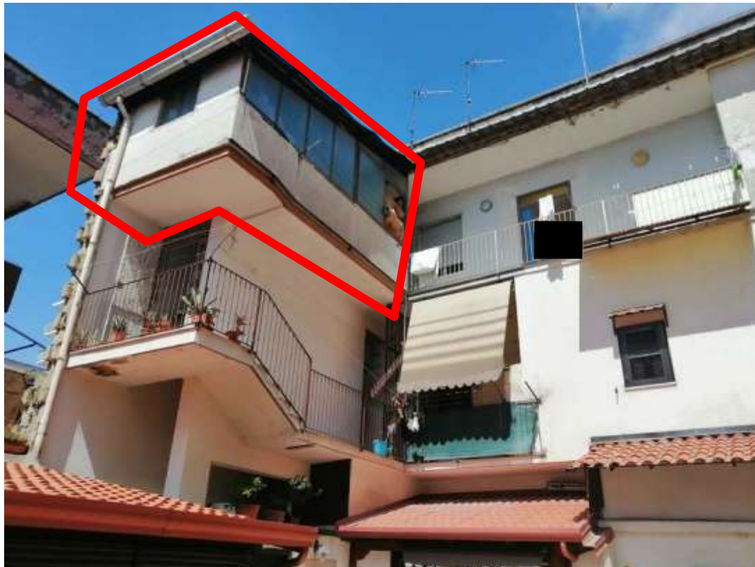
Foto n. 4 – Ballatoio del vano scala posto al secondo piano, prospiciente l'ingresso dell'appartamento, chiuso abusivamente
