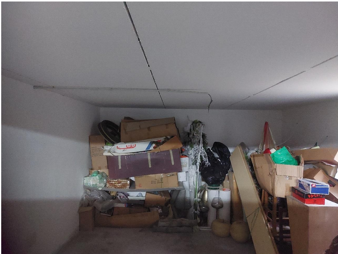
FOTO 6 – INTERNO DEL BOX
