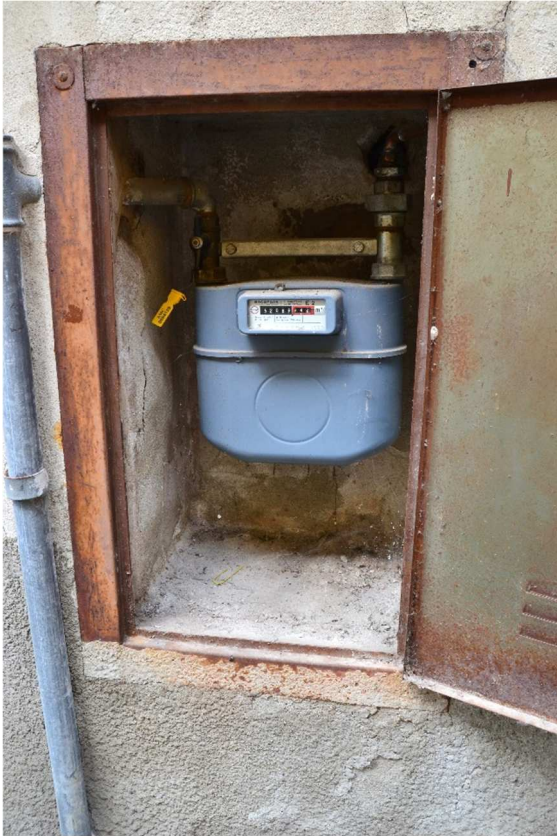
Vista fotografica Contatore gas metano posto sulla facciata verso via V. Gioberti
