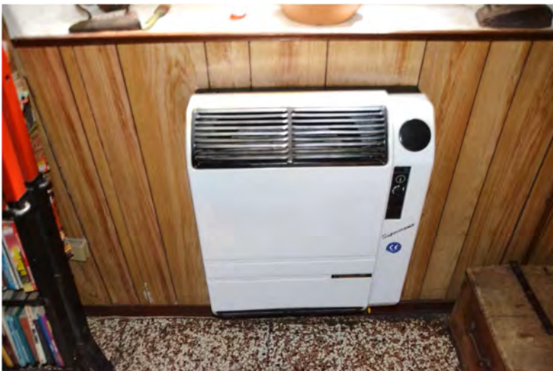
Vista fotografica Ventilconvettore
