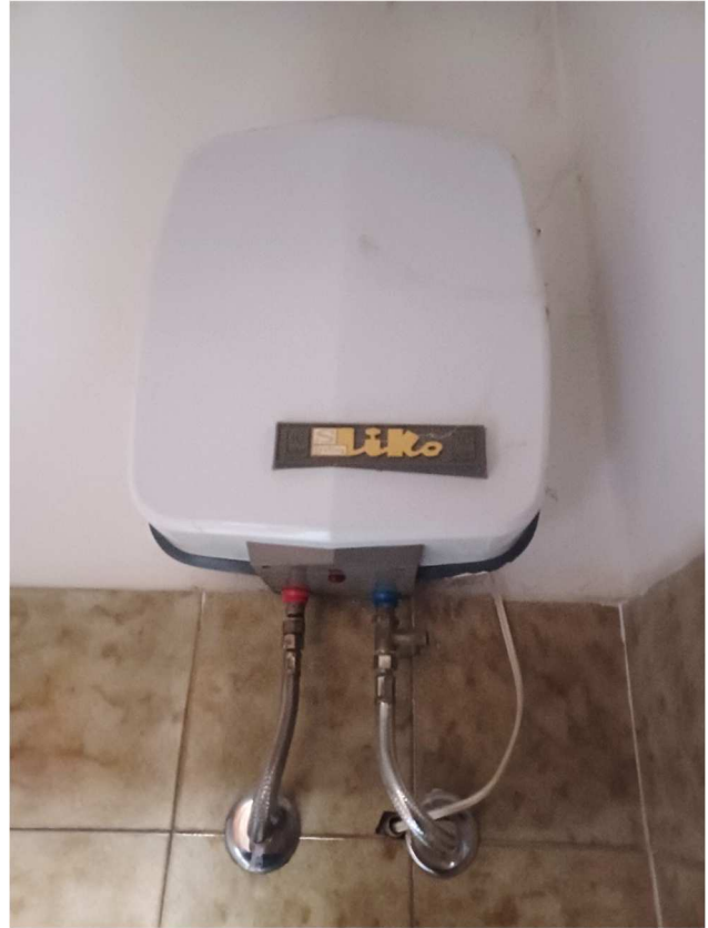
Vista fotografica boiler posto nel bagno
