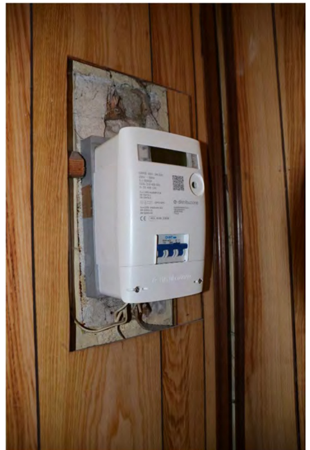
Vista fotografica contatore energia elettrica posto nell'ingresso
