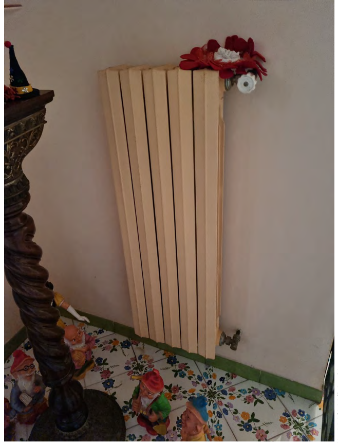
Foto 17 – Termosifone in ghisa
