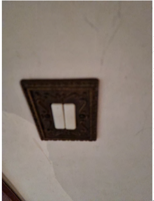
Foto 19 – Impianto elettrico vetusto
