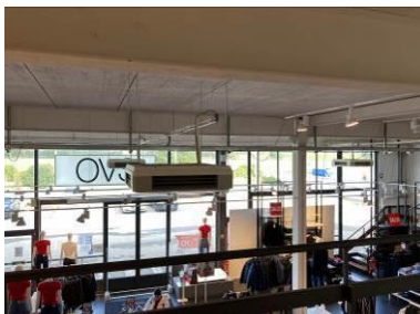
1 delle 12 ventilanti interne
