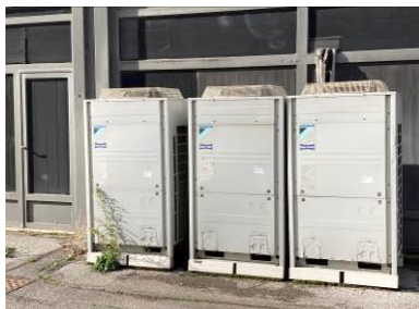
3 delle sei pompe di calore
