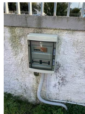
Quadro elettrico esterno
