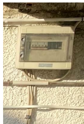
Quadro el. Pompa di calore
