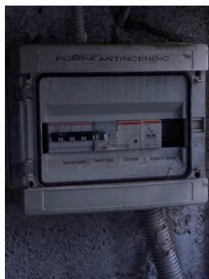
Quadro el. gruppo antincendio
