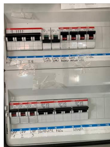
Quadro elettrico uffici
