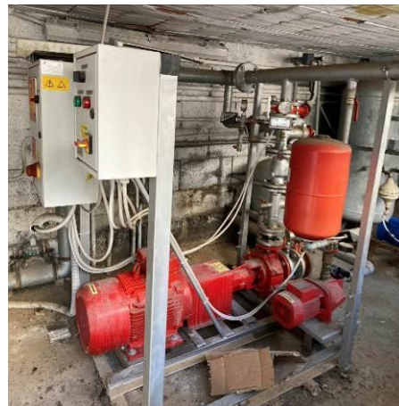
Gruppo pompe antincendio
