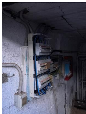
Quadro elettrico magazzino
