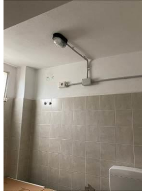
Impianto in tubazione PVC
