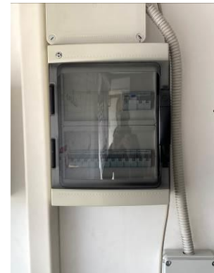
Quadro elettrico piano ammezzato
