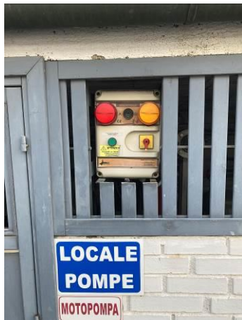
Interruttori esterni poma antincendio
