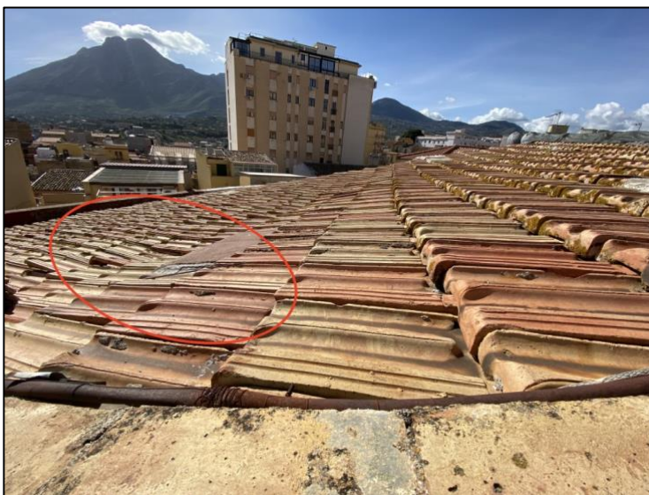
FOTO 3 Tetto a copertura dell'immobile Prossimo al crollo
