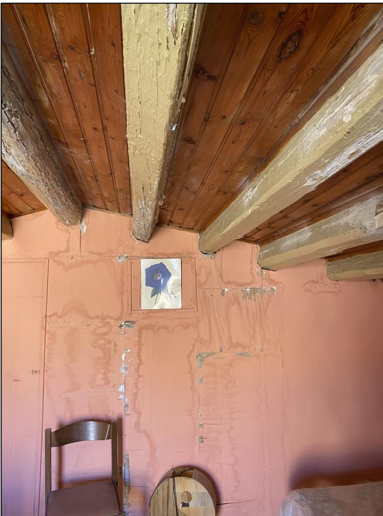
Foto 5 Tetto e travi avvallate proprietà soffitta Sig.ra Morreale
