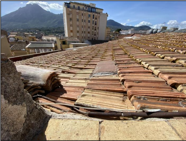
FOTO 4 Tetto e travi avvallate soffitta proprietà Sig.ra Morreale
