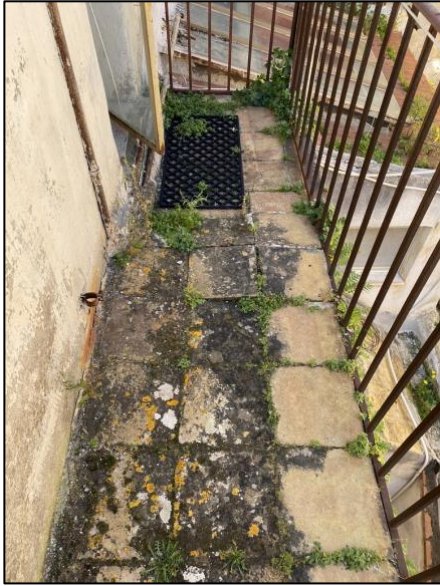
Foto 6 Balcone pericolante per accedere al terrazzino
