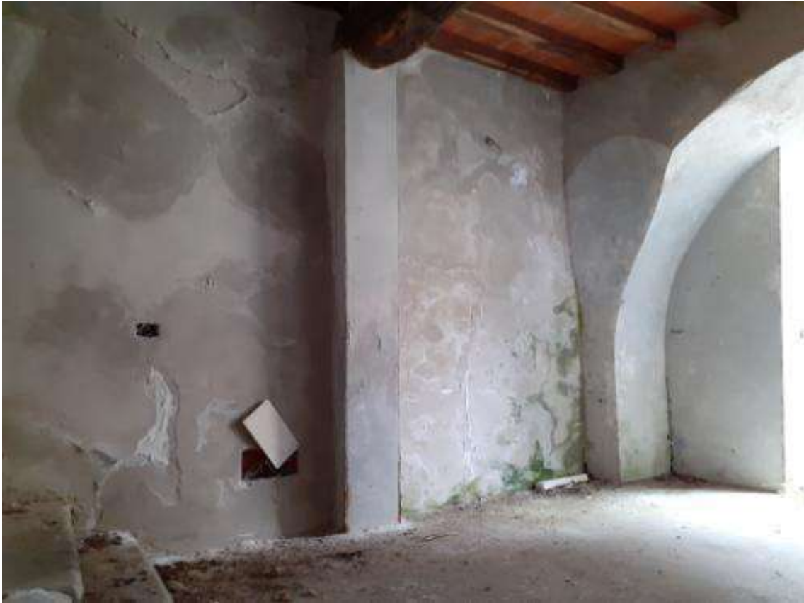
Foto 5 – parete piano seminterrato contro terra interessata dall'umido
