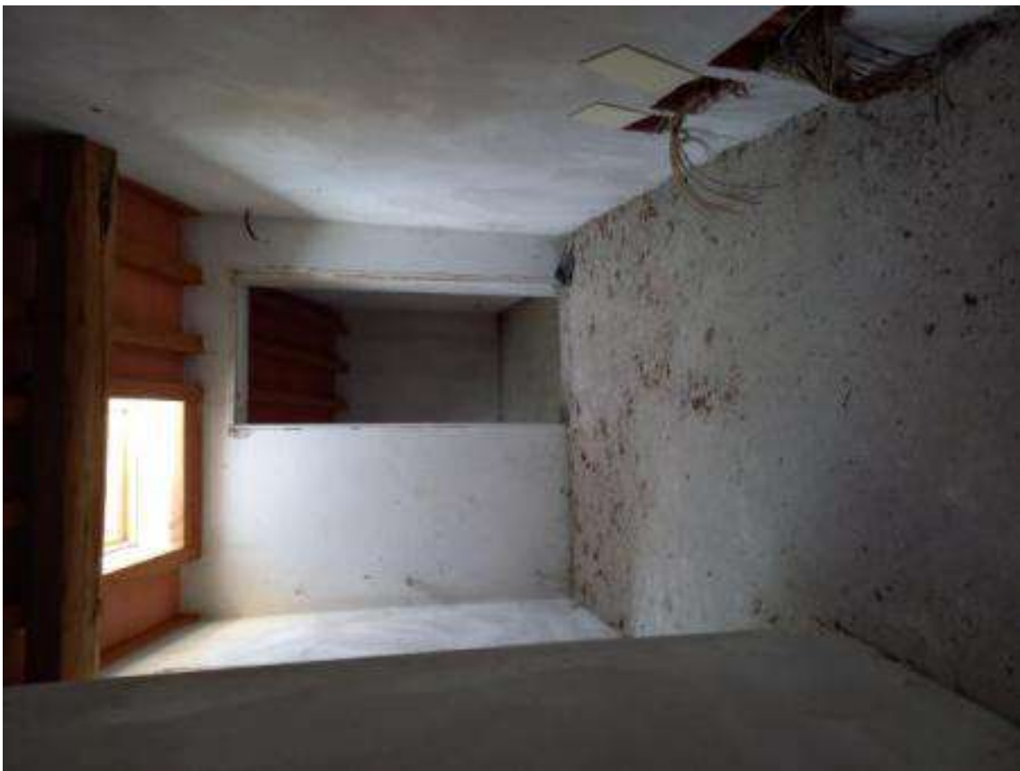
Foto 18 - suddivisione interna piano primo ed individuazione apertura in copertura
