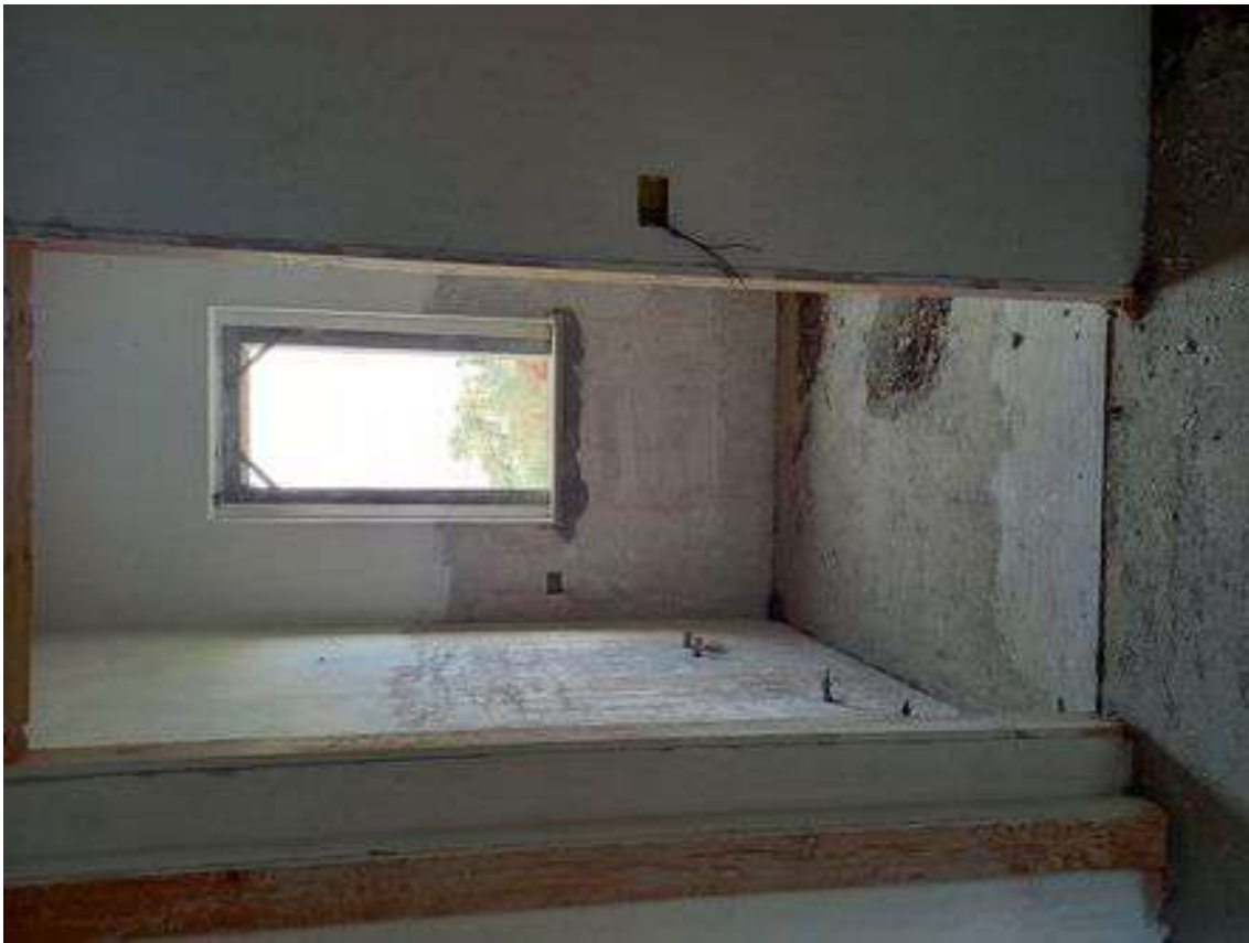
Foto 5 – locale con attacchi wc piano terra
