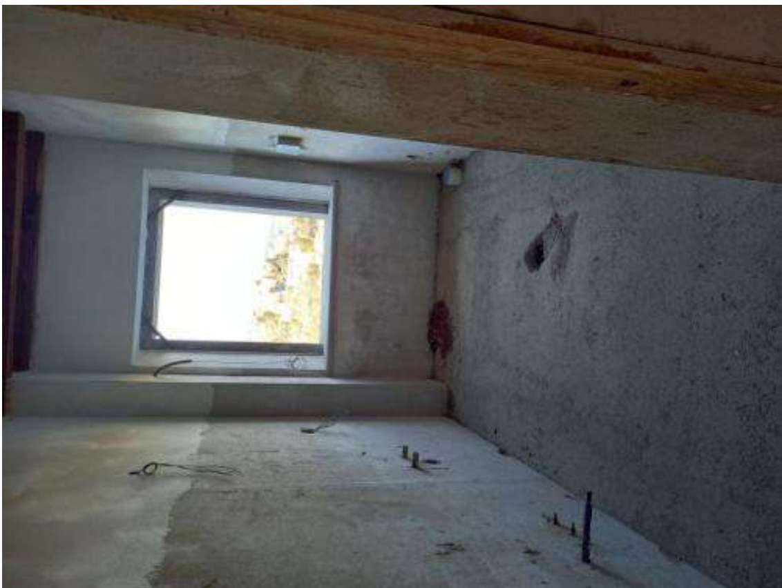
Foto 12 – locale con attacchi wc piano terra
