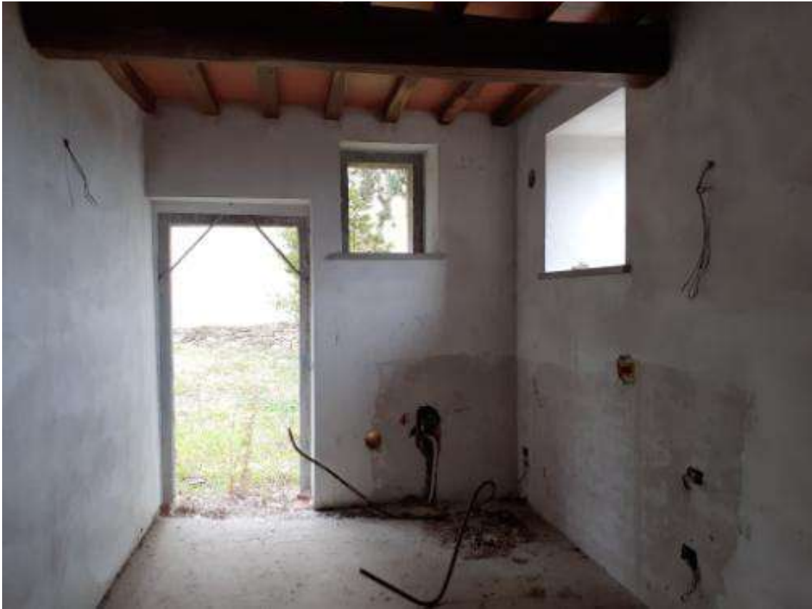
Foto 1 – attacchi cucina piano seminterrato
