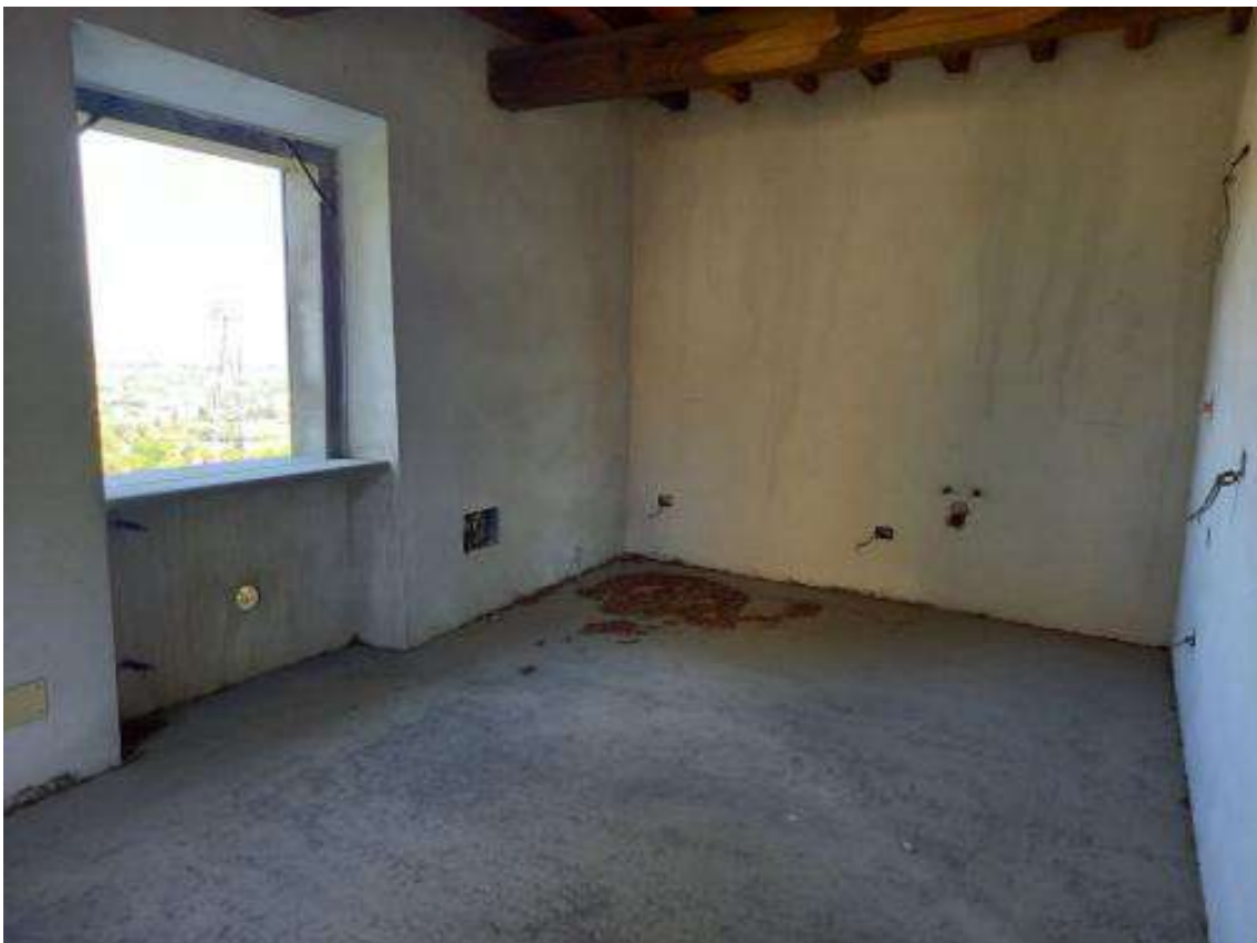
Foto 10 – attacchi cucina locale piano terra
