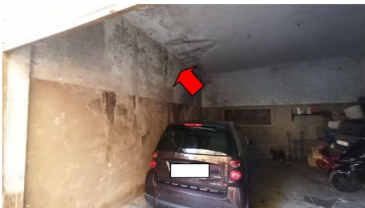
FOTO 22 – DETTAGLIO INFILTRAZIONE DAL SOPRASTANTE TERRAZZO
