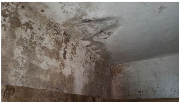
FOTO 23 – DETTAGLIO INFILTRAZIONE DAL SOPRASTANTE TERRAZZO
