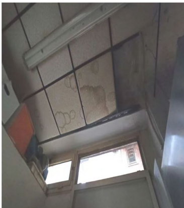
FOTO 18 - INFILTRAZIONE SU SOLAIO E CONTROSOFFITTO
