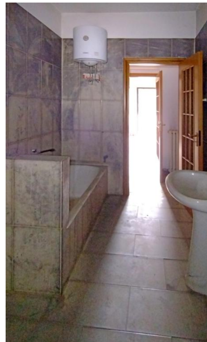
Boiler elettrico sopra la vasca
