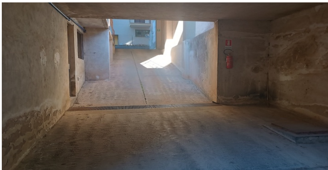
Foto 5 Lotto 1 – Rampa di accesso ai garage da piano sotterraneo al piano terra
