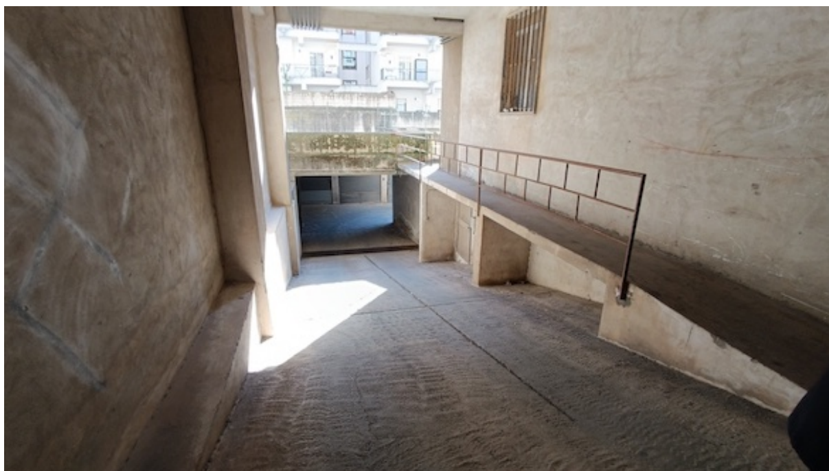
Foto 4 Lotto 1 – Rampa di accesso ai garage da piano terra al piano sotterraneo
