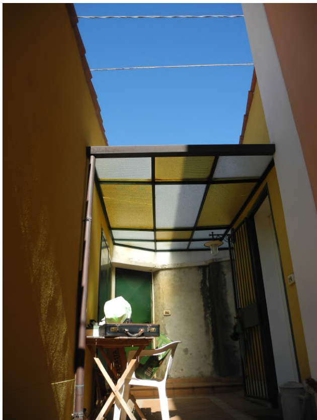
FOTO 13 – tettoia presente tra box auto e parete “lato cucina”
