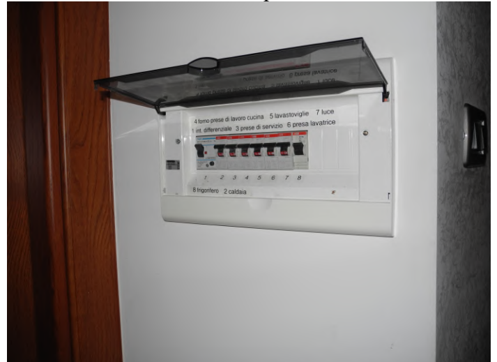
FOTO 58 – terzo quadro elettrico
