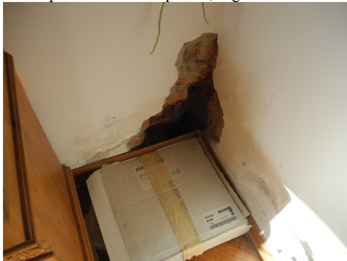
FOTO 29 – danneggiamento da infiltrazione a livello pavimento saletta pranzo, angolo destro
