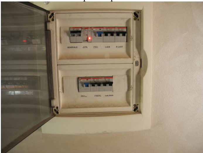
FOTO 56 – primo quadro elettrico
