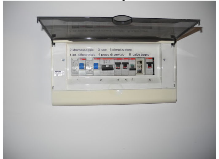
FOTO 57 – secondo quadro elettrico
