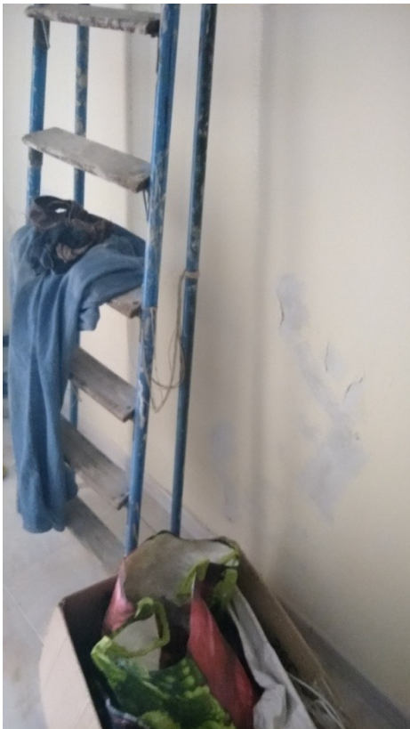
Umidità sui muri al piano terra
