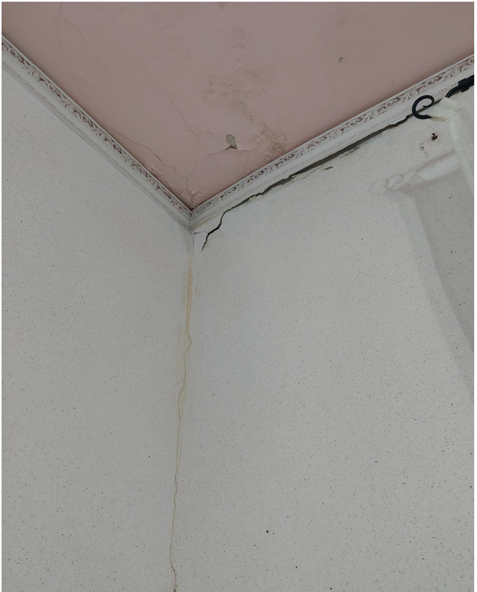
Foto n 6 Particolare ammaloramento camera da letto principale..
