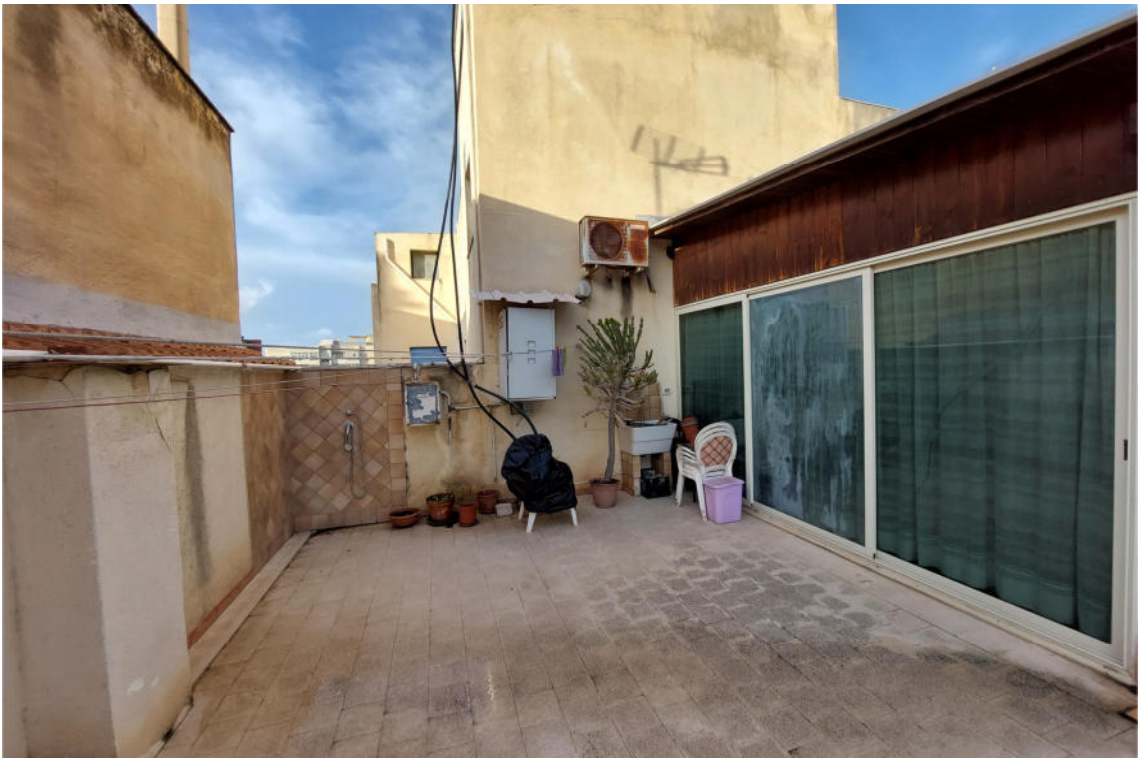
foto 13-14 Veranda precaria lignea con chiusura verticale.
