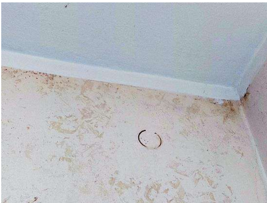
52 = Abitazione di 2°P – vano M (part. muffa)
