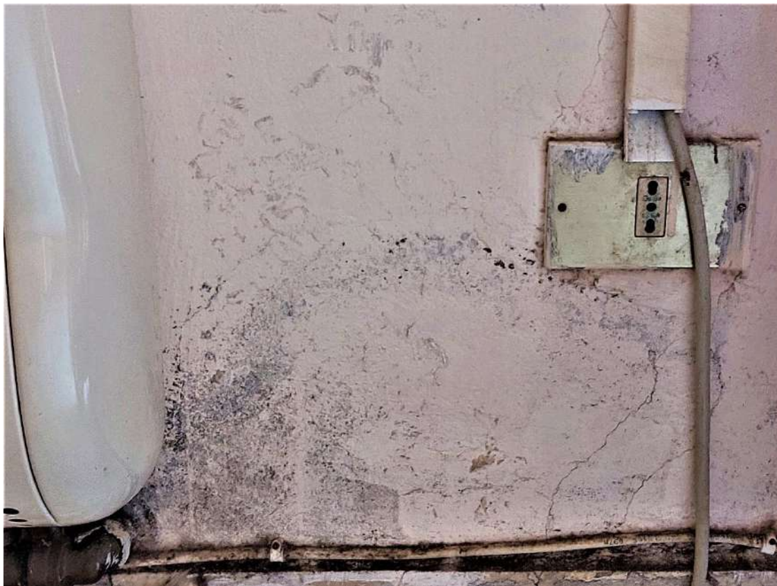
51 = Abitazione di 2°P – vano M (part. muffa)
