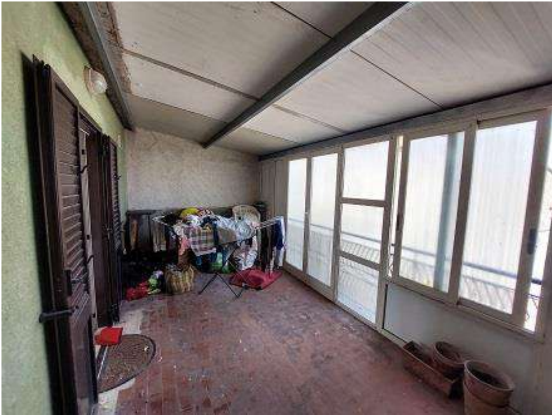
87 = Abitazione di 3°P – vano S (terrazza con veranda abusiva)
