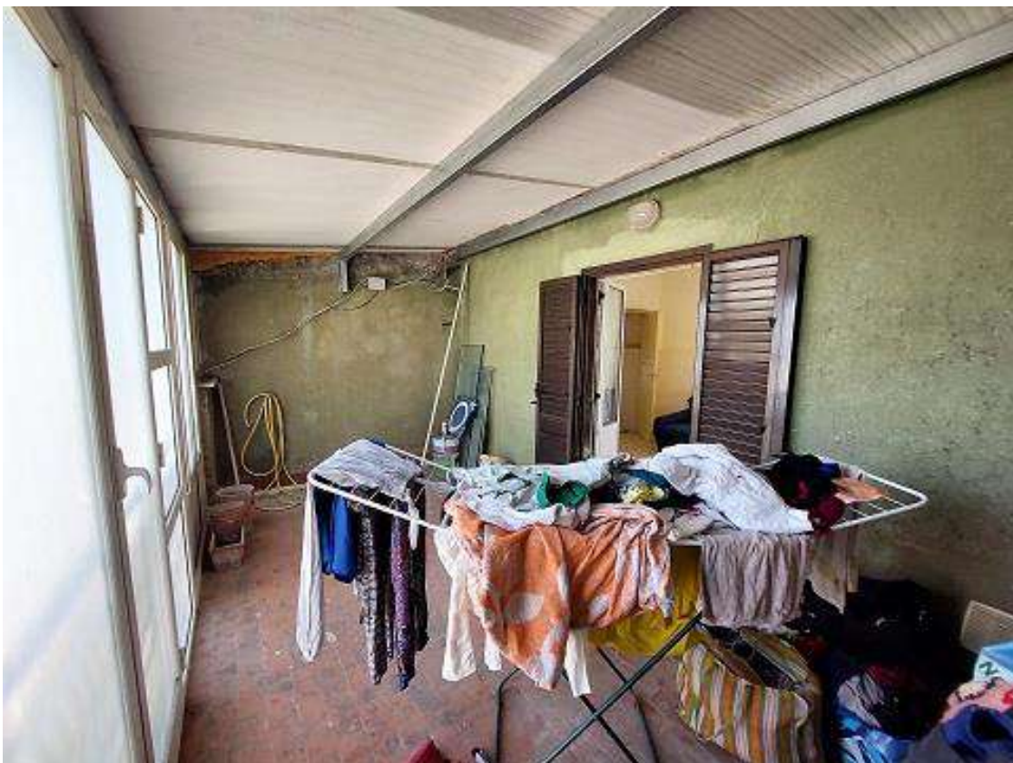
88 = Abitazione di 3°P – vano S (terrazza con veranda abusiva)
