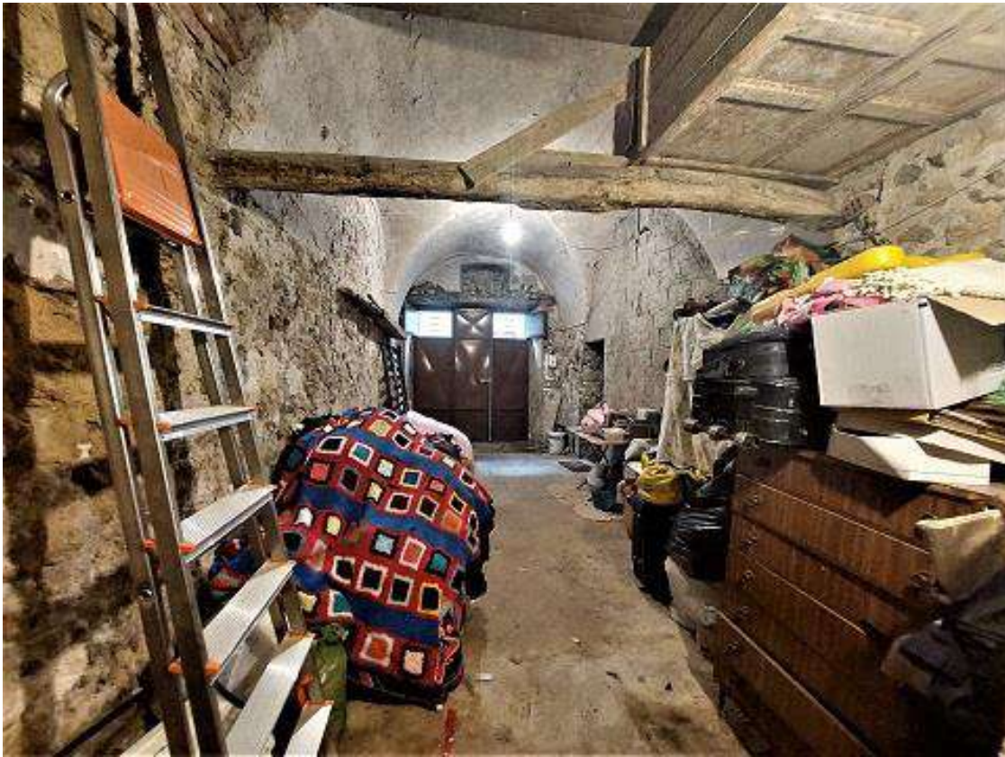
27 = Magazzino di P.T. – vano D (vista verso vano E prospiciente la via Maria SS. Dell’Aiuto)
