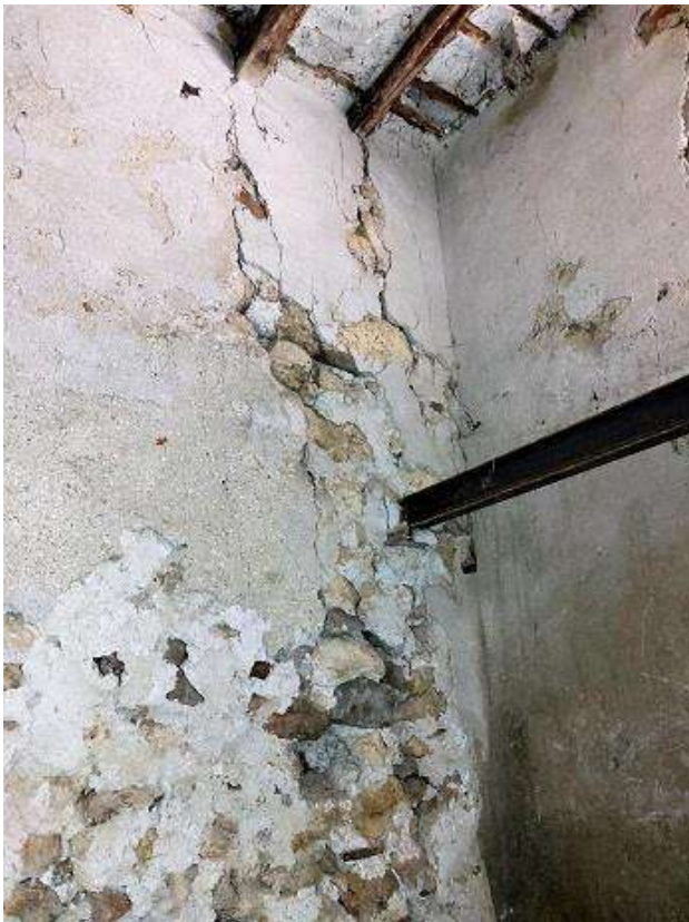
15 = Magazzino di P.T. – vano C (part. della muratura)
