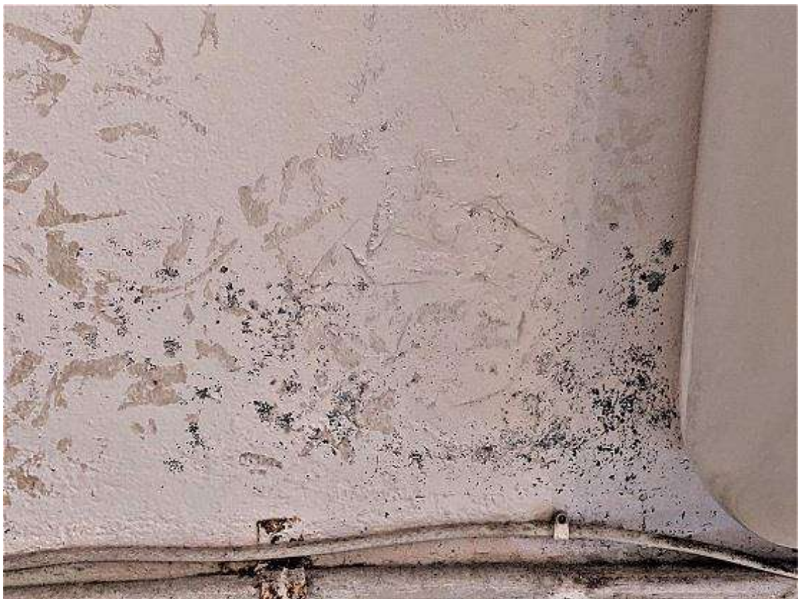
50 = Abitazione di 2°P – vano M (part. muffa)
