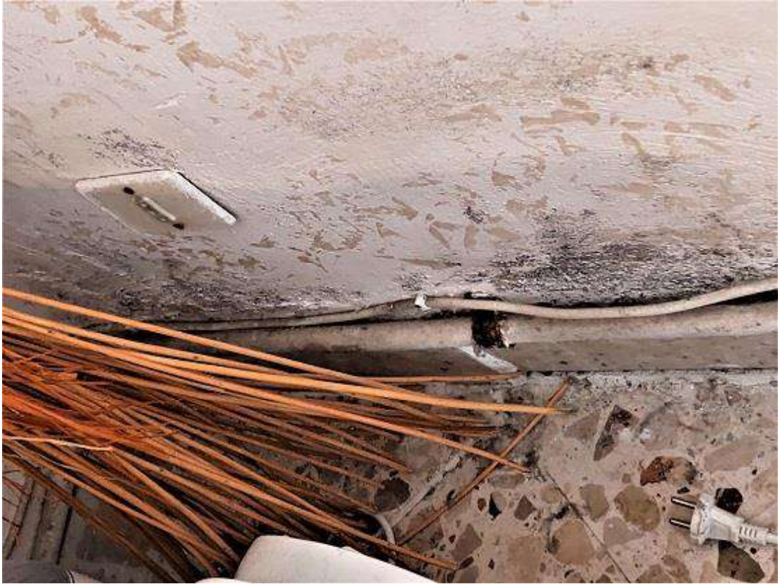
49 = Abitazione di 2°P – vano M (part. muffa)
