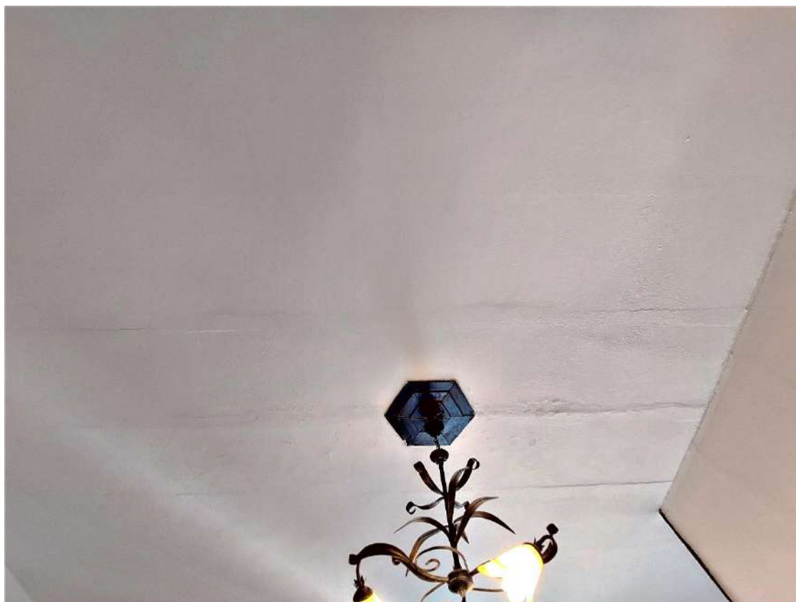
55 = Abitazione di 2°P – vano M (part. soffitto)
