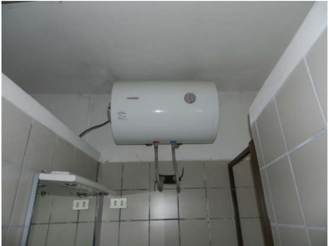
Boiler a servizio dei bagni
